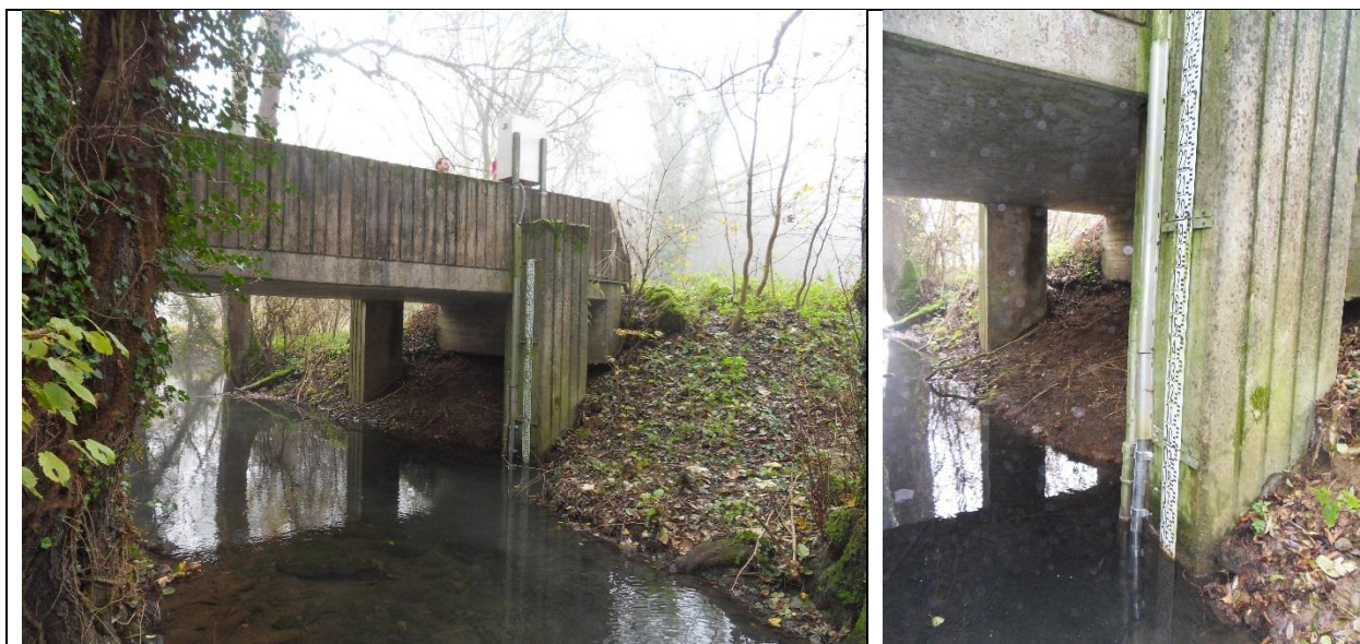
Illustration 10 : Equipement de la station du Conroy
