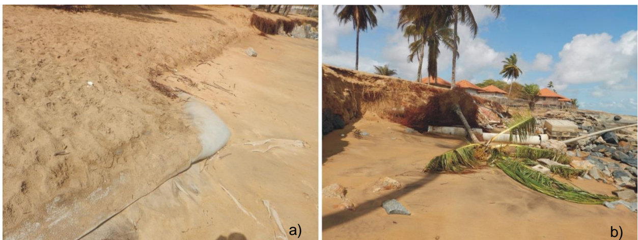
Illustration 25 : Dégradation du stabiplage (a) ; chute des cocotiers et présence de gravats (b) octobre 2016.
