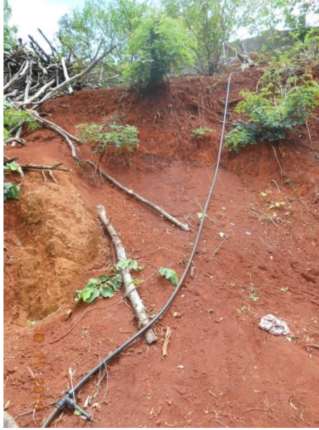
Illustration 19 : Glissement superficiel de talus de déblai ou de remblai anthropique
