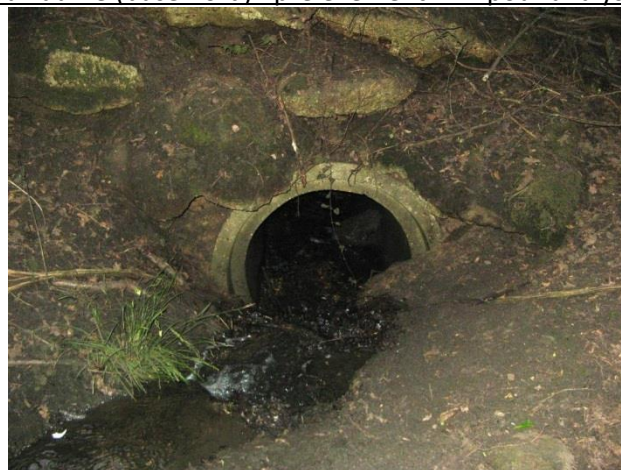
Point d'observation n° 7 - Eaux s'engouffrant à la Fosse Guillaume (buse nord) : prélèvement n° 2 pour analyses
