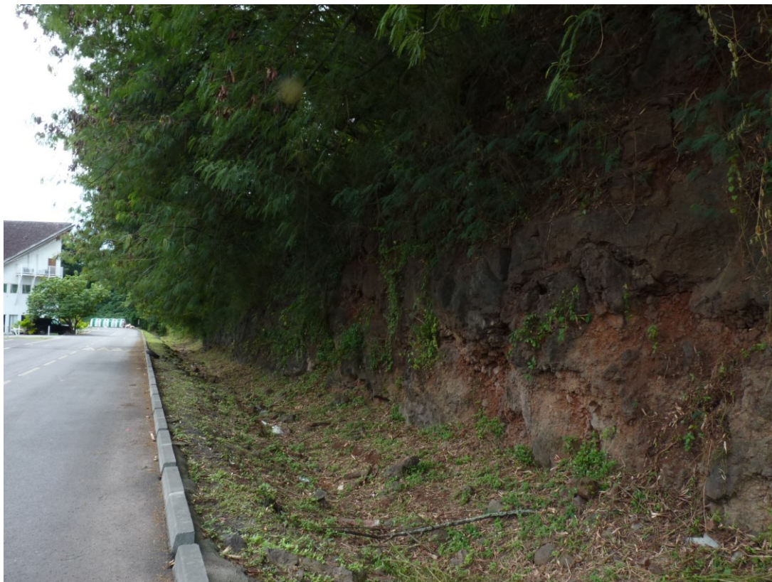
Illustration 8 : Fossé de réception des blocs en pied de pente, dans la partie sud du versant
