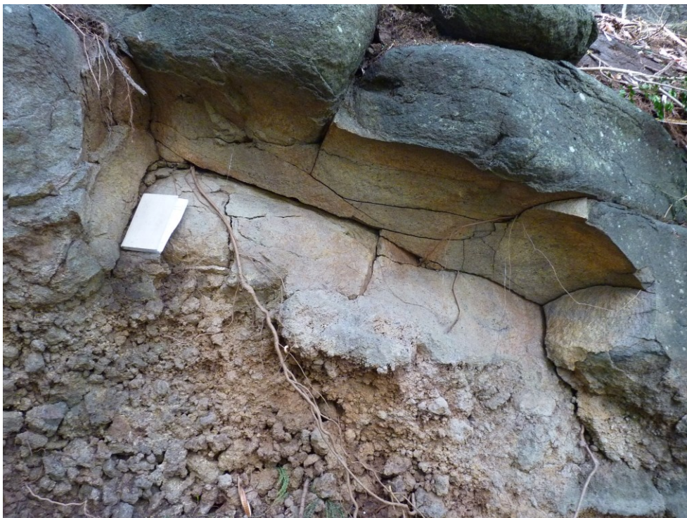
Illustration 6 : Cicatrice de bloc plurimétrique destabilisé par l'action conjointe du sous-cavage, des diaclases et des racines.
