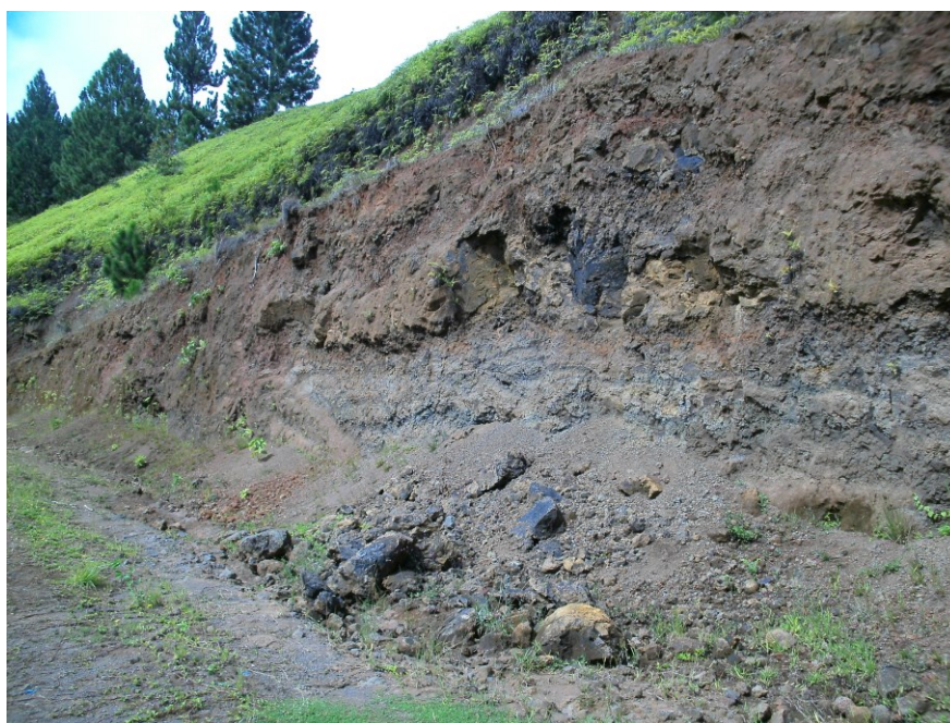
Illustration 9 : Talus le long de la route d'accès au lotissement. Affleurement de mamu II fortement sujet à l'érosion.
