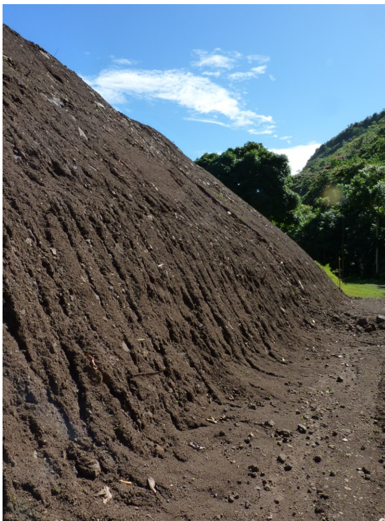
Illustration 9 : Ravinement du remblai lié à l'absence de gestion des eaux pluviales sur des pentes raides
