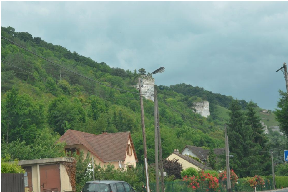
Illustration 26 - Exemple de pinacles rocheux situés à l'arrière de maisons d'habitation. Commune du Thuit
