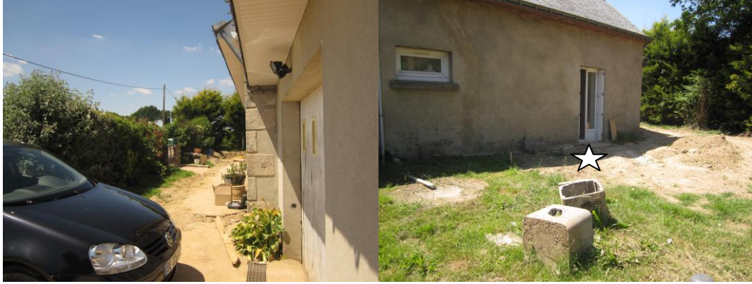
Illustration 19 : Photographies des localisations des travaux de tranchées entrepris devant et derrière l'habitation et du pompage entrepris à l'arrière de l'habitation (étoile)
