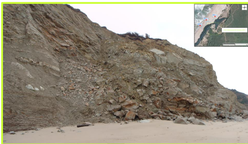
Figure 20 : Prise de vue n°1 (face Nord) de l'éboulement d'Erretegia (14/12/2013).
