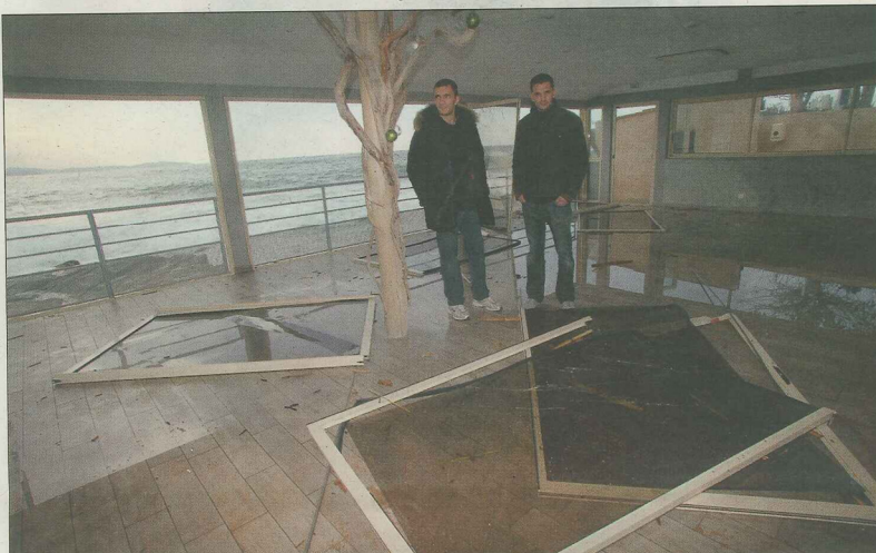
L'Altru Versu des frères Mezzacqui, juste après la chapelle des Grecs, a subi de gros dégâts lors du coup de tabac de vendredi : baies vitrées entièrement détruites, canalisations « éclatées », cuisine inondée... Le restaurant qui a ouvert ses portes cet été et qui emploie 14 personnes n'est pas prêt de rouvrir ses portes. (Photos Alain Pistoresi)
