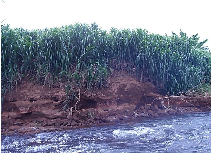
Illustration 36 : Érosion plus ou moins prononcée suivant les phases de dépôts, provoquant ensuite le sous-cavage des horizons supérieurs (Point 325)
