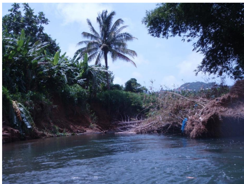
Illustration 64 : Érosion de la berge rive gauche, accentuée par l'embâcle provoqué par les bambous (Point 250)
