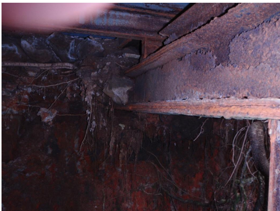
Illustration 72 : Érosion des appuis des travées de rives du pont de Ressource.
