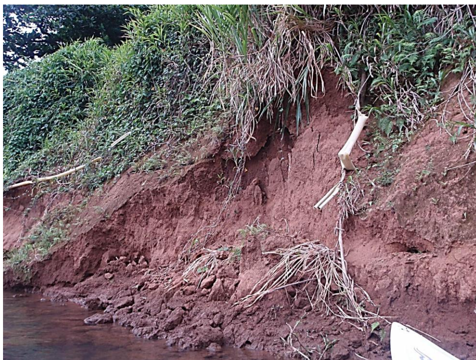
Illustration 39 : Loupe de glissement entraînée par déstabilisation hydraulique en pied (Point 221)
