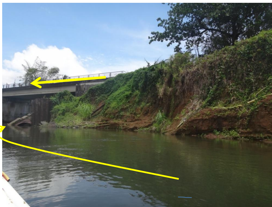
Illustration 71 : Érosion de la berge rive droite, modifiant l'angle d'attaque de la rivière sur la culée du pont de Soudon (Point 221)
