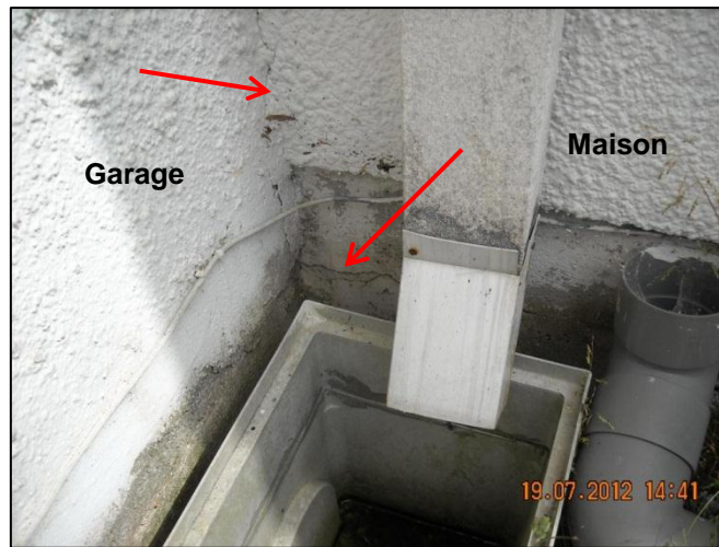
Figure 12 : Façade nord-ouest : fissures verticale et horizontale entre la maison et le garage
