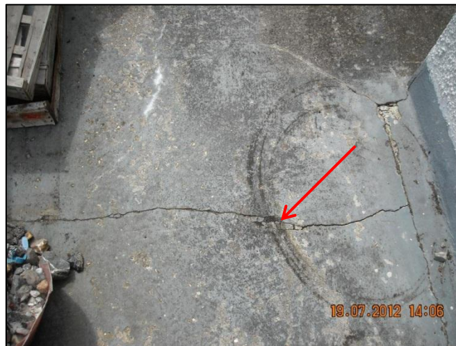
Figure 29 : Fissure sur le sol de la terrasse près de la chaufferie
