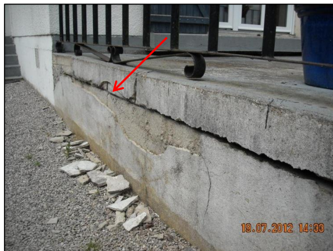
Figure 27 : Fissure horizontale fermée le long de la dalle de la terrasse (côté sud-ouest)
