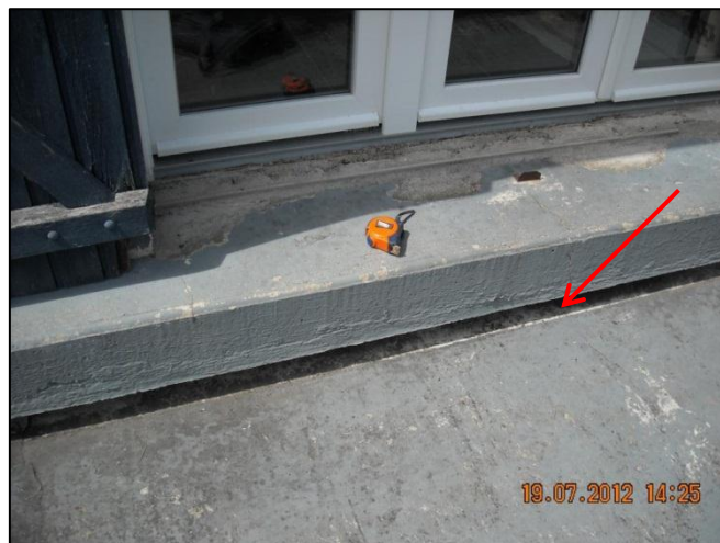
Figure 30 : Affaissement de la terrasse
