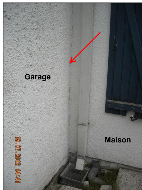
Figure 13 : Façade nord-ouest : fissure verticale entre la maison et le garage
