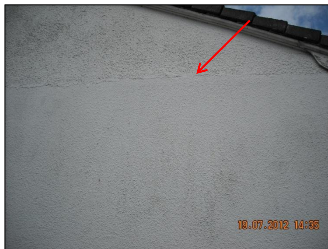
Figure 10 : Façade sud-ouest de la maison : fissure horizontale au sommet du rez-de-chaussée
