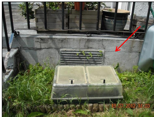
Figure 24 : Fissure horizontale fermée le long de la dalle de la terrasse (côté sud-est)
