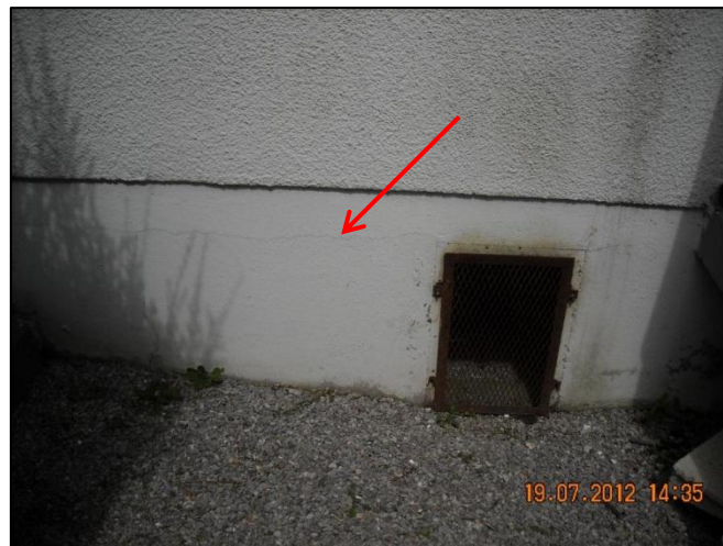
Figure 9 : Façade sud-ouest de la maison : fissure horizontale au sommet du vide sanitaire
