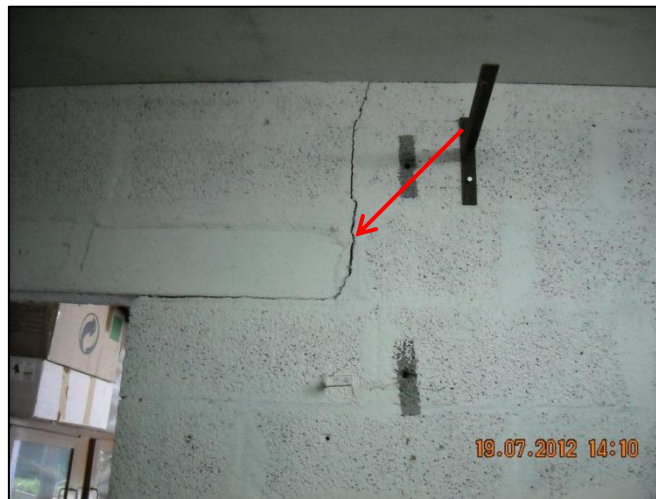
Figure 19 : Fissure ouverte sur le mur séparant la chaufferie du garage (côté garage)
