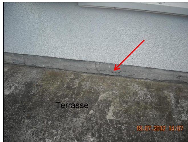
Figure 15 : Fissure horizontale en bas du mur sud-est de la maison
