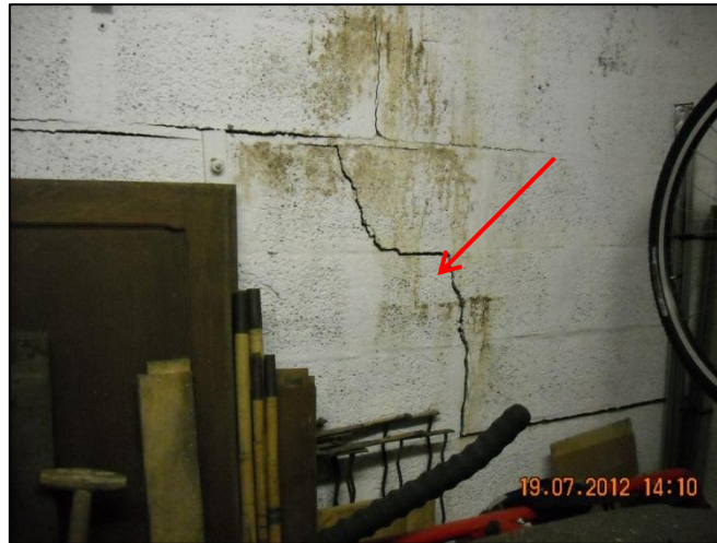
Figure 18 : Fissure ouverte sur le mur séparant la chaufferie du garage (côté garage)
