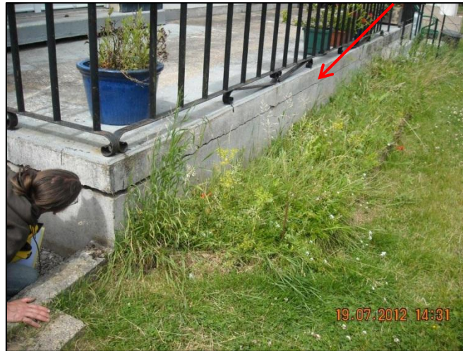
Figure 25 : Fissure horizontale fermée le long de la dalle de la terrasse (côté sud-est et coin sud)
