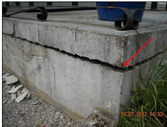
Figure 26 : Fissure horizontale fermée le long de la dalle de la terrasse (coin sud)
