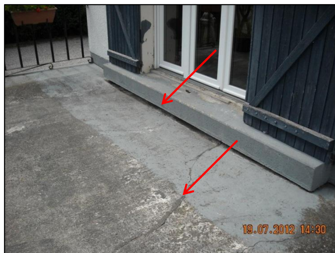
Figure 31 : Affaissement de la terrasse et fissures au sol
