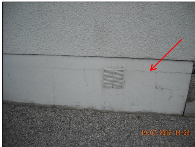
Figure 8 : Façade sud-ouest de la maison : fissure horizontale au sommet du vide sanitaire
