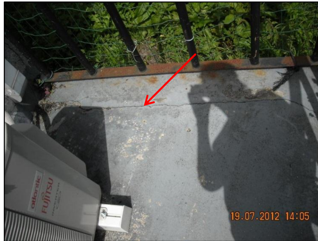
Figure 28 : Fissure sur le sol de la terrasse près de la chaufferie, au coin nord-est de la terrasse
