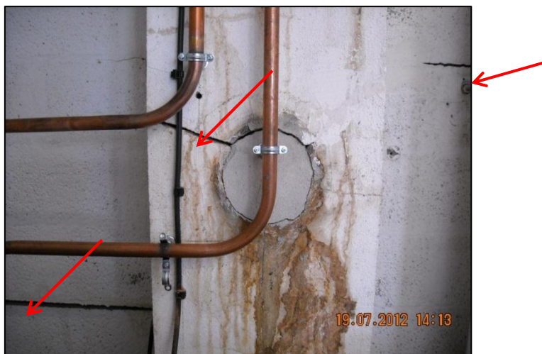
Figure 21 : Fissure ouverte sur le mur séparant la chaufferie du garage (côté garage)
