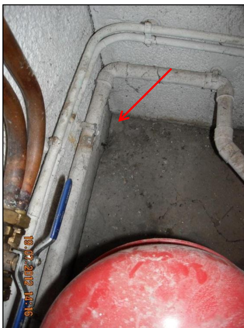
Figure 22 : Affaissement de la dalle dans la chaufferie
