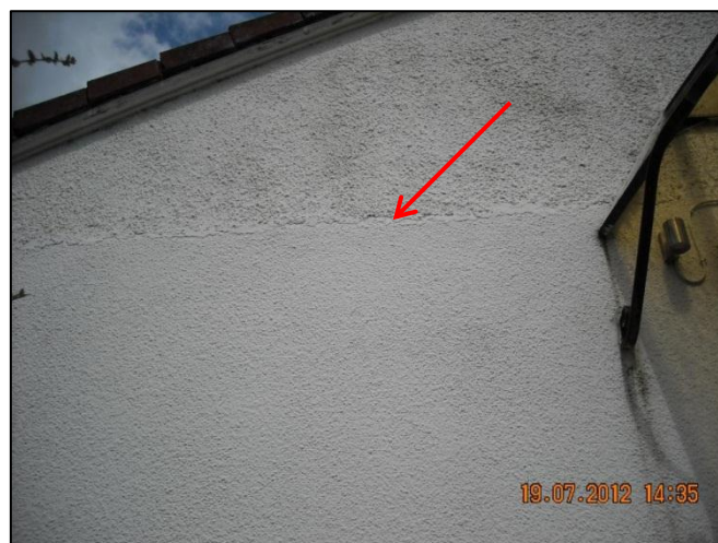
Figure 11 : Façade sud-ouest de la maison : fissure horizontale au sommet du rez-de-chaussée
