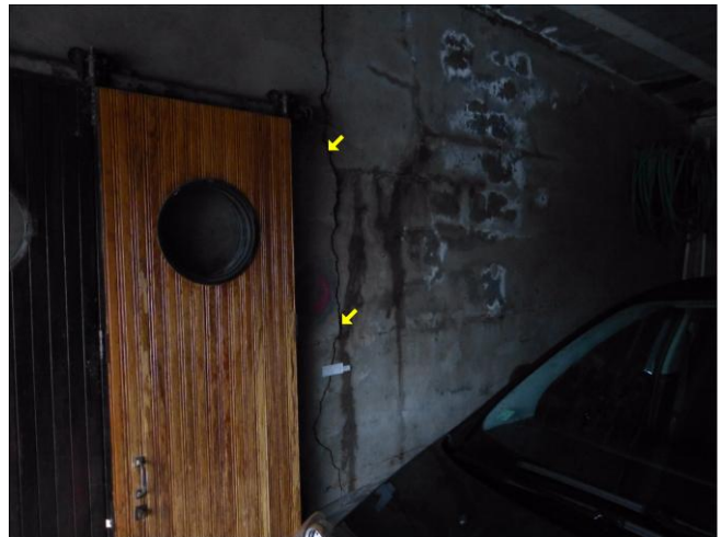
Illustration 9 : Garage fissuré (photo BRGM)
