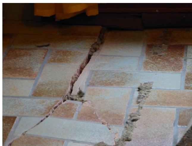
Illustration 5 : Détail de la fissure dans la salle à manger (photo BRGM)
