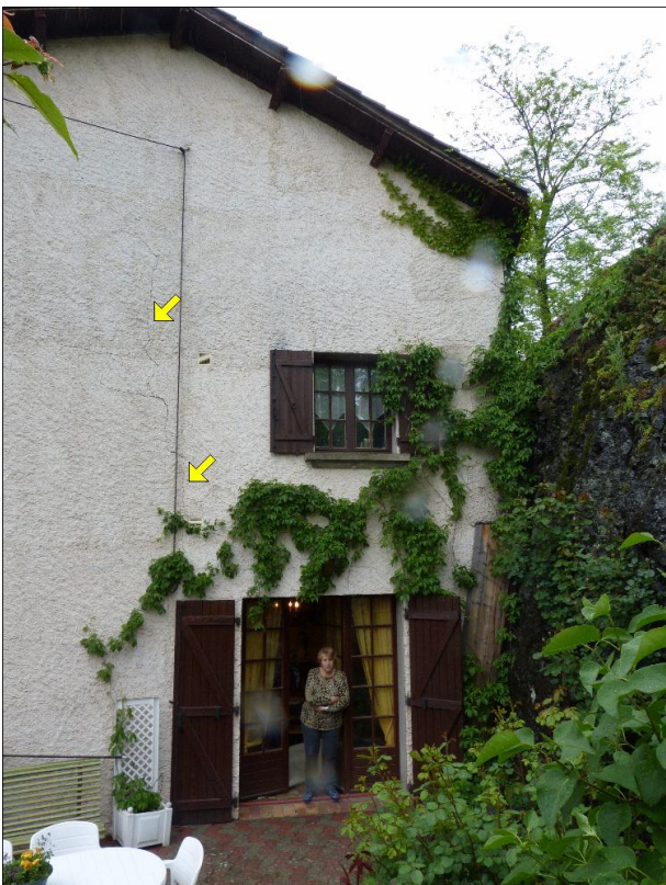
Illustration 8 : Façade sud fissurée (photo BRGM)
