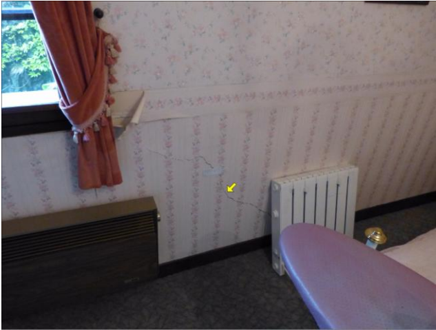
Illustration 6 : Fissure dans la chambre (photo BRGM)
