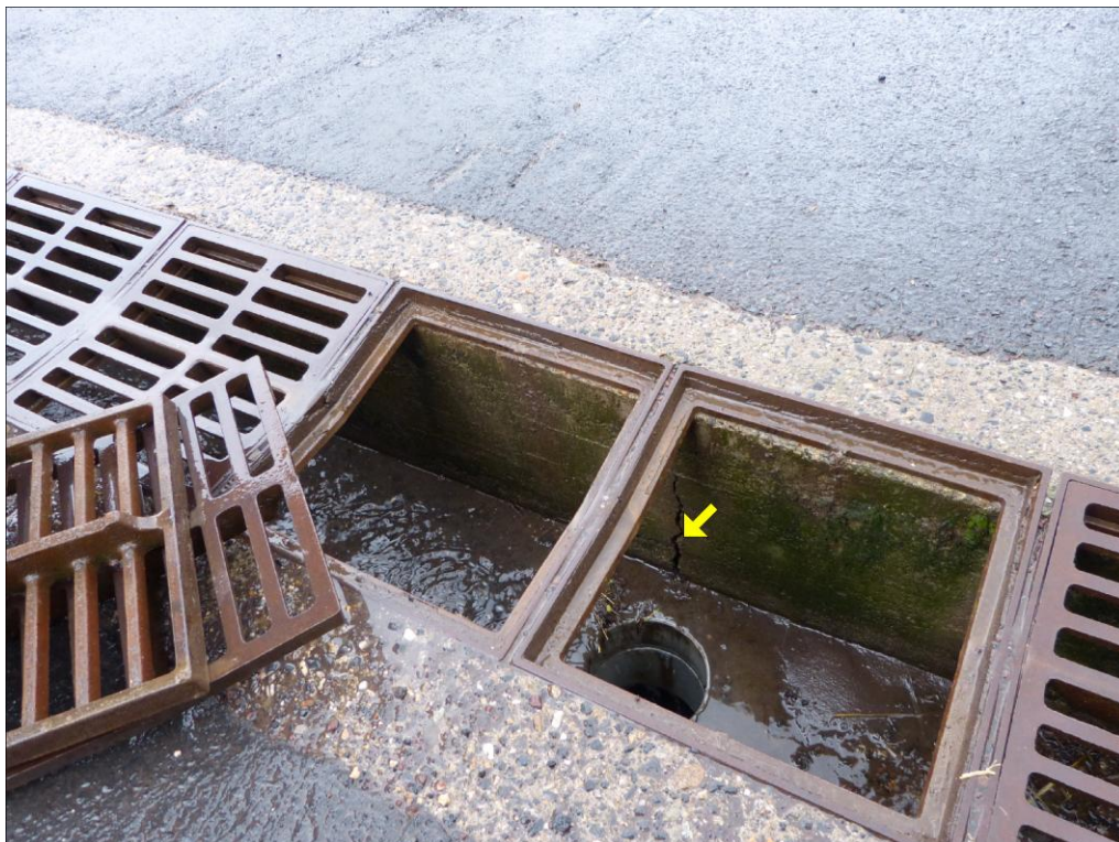
Illustration 11 : Fissuration de l'exutoire de l'avaloir-grille (photo BRGM)
