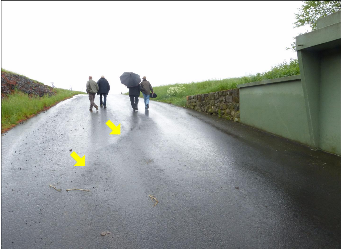
Illustration 12 : Léger affaissement de la chaussée devant le château d'eau (photo BRGM)
