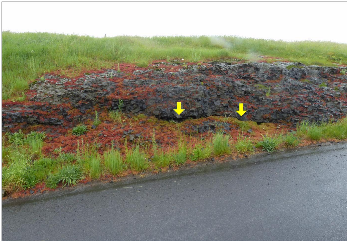
Illustration 13 : Début d'affaissement du talus devant le château d'eau (photo BRGM)
