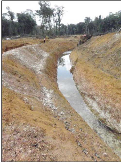
Figure 10 :Photo d'un canal de dérivation creusé dans le terrain naturel et encadré par des « levées de terre ».
