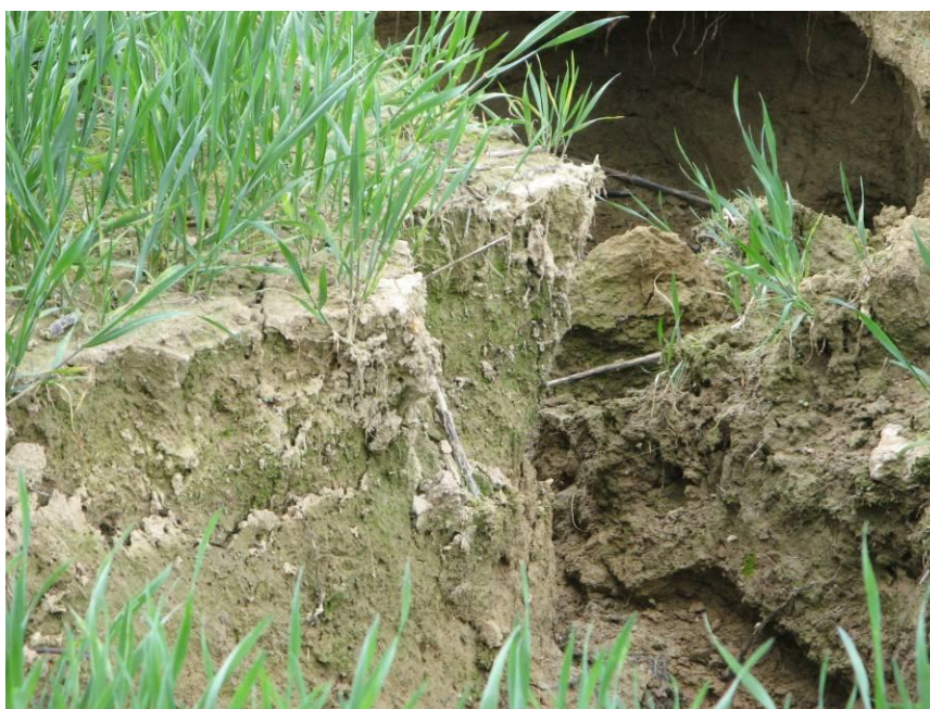
Illustration 9 – 3 ème effondrement (source : BRGM).
