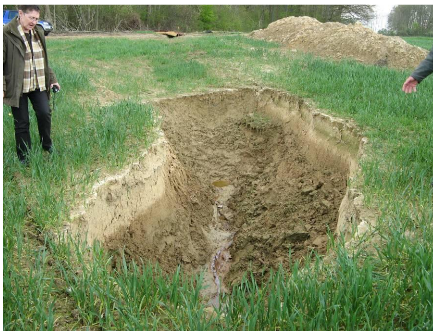
Illustration 5 – 1 er effondrement (vue direction sud, le tas de sol observable à droit de la photographie a été mis en place par l'exploitant de la parcelle en prévision d'un remblaiement) (Source : BRGM).
