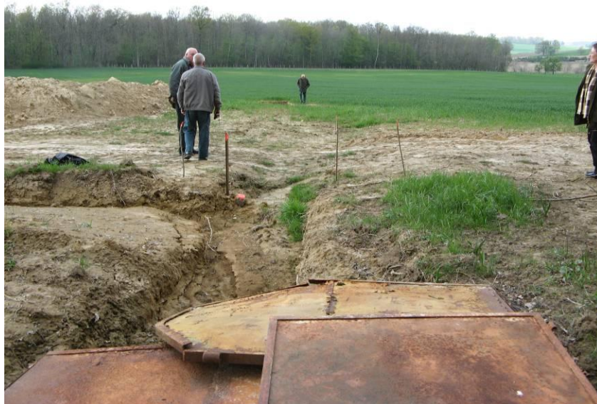
Illustration 7 – Débouché des buses mises en place pour drainer les eaux de ruissellement en amont de la zone impactée
