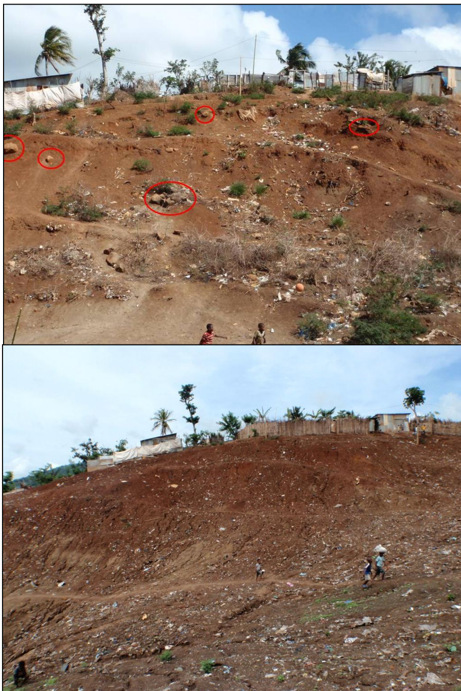
Illustration 1 – En haut, vue de la zone d'étude le 05/08/11 : colluvions à blocs décimétriques. En bas, vue de la zone d'étude le 14/12/11 : purge des blocs décimétriques. Photos BRGM.
