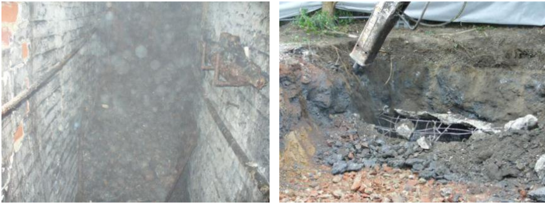
Illustration 27 - Galerie technique du puits 11 détruite et comblée lors des travaux.
