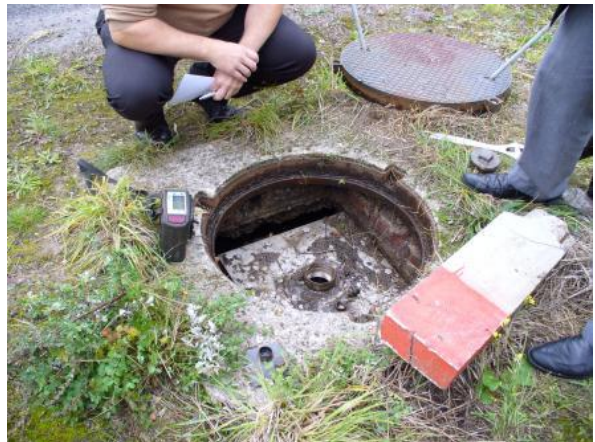
Illustration 23 - Caisson de contrôle désolidarisé de la dalle du puits 4 de Sallaumines (62), constat de 2008.
