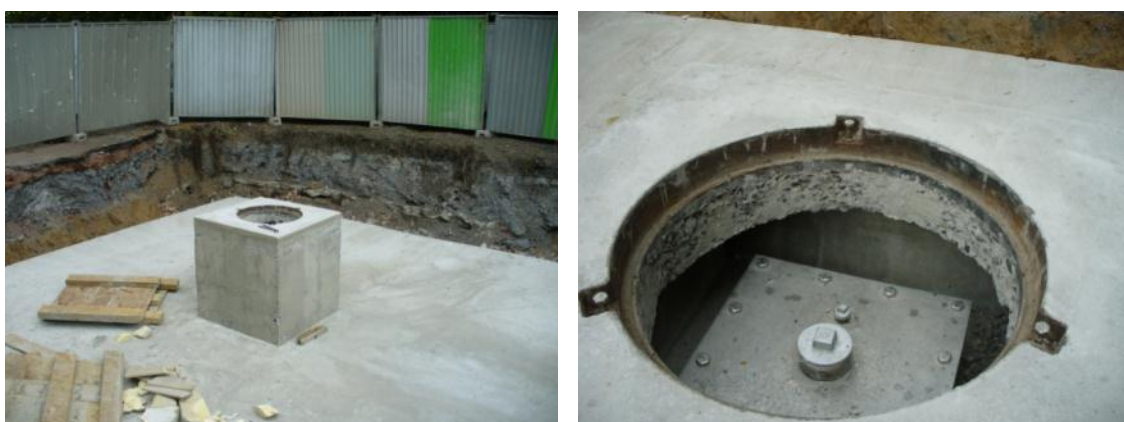
Illustration 32 - Cheminée béton et son équipement de contrôle.
