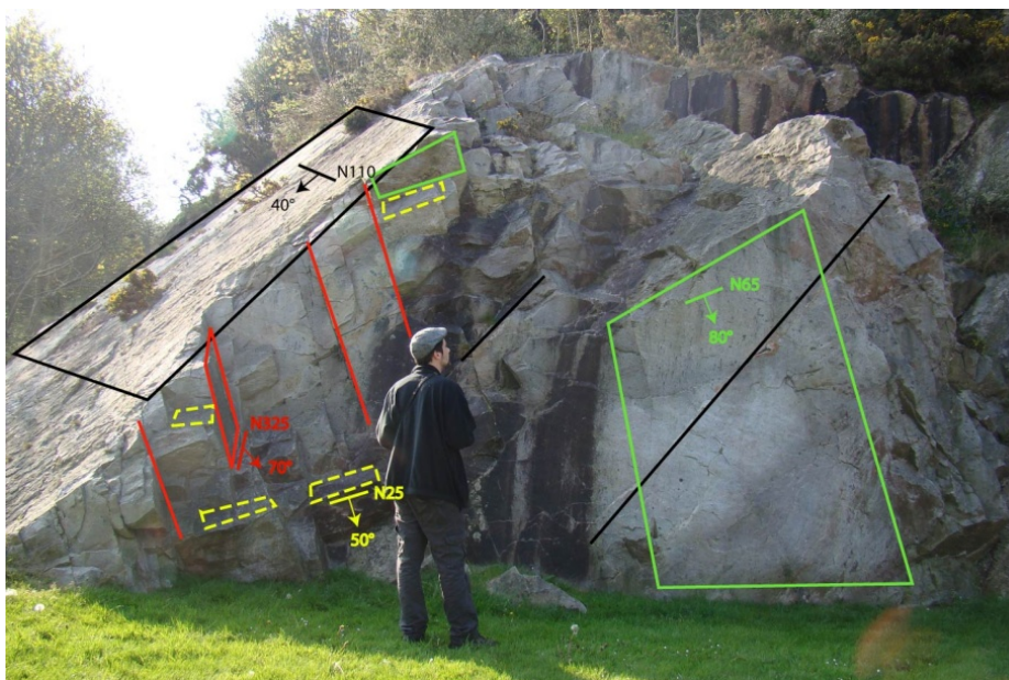
Illustration 14 : Pied du versant Nord de la Montagne du Roule, Cherbourg. Mise en évidence des différentes familles de fractures relevées : fractures d'ordre 1 en trait plein, fractures d'ordre 2 en pointillés
