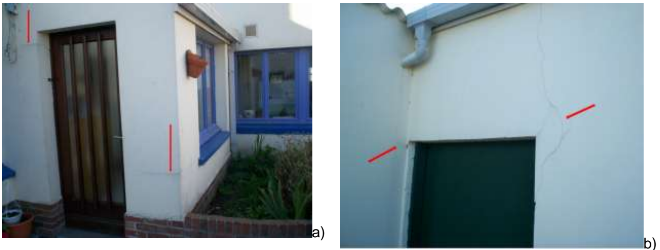
Figure 16 : Deux vues de fissures affectant les façades du 1010 rue Verte.
