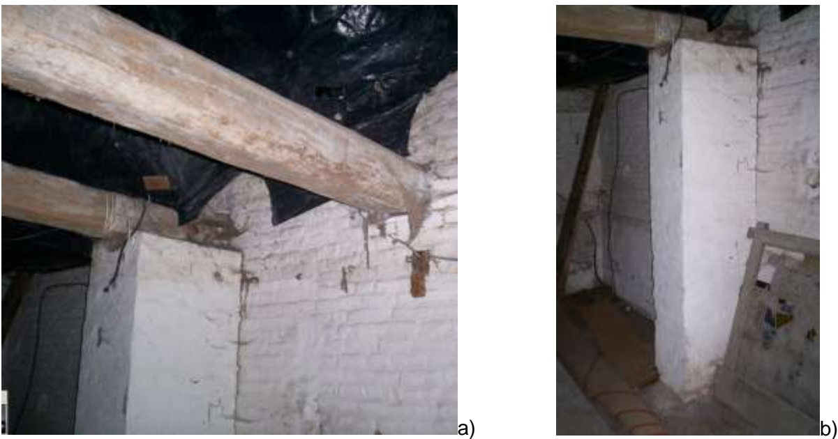
Figure 13 : Intérieur de la Grange 2. a) Poutre décalée côté nord est ; b) Fissure entre le mur et le pilier (côté nord-est)
