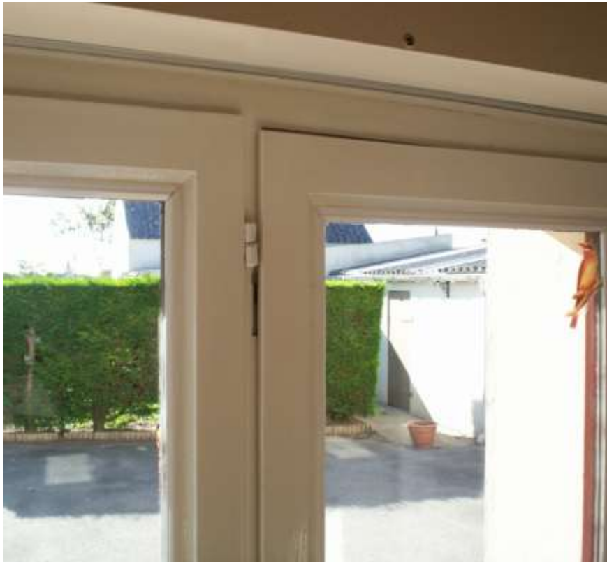
Figure 21 : Défaut d'alignement des portes fenêtres du rez-de-chaussée.
