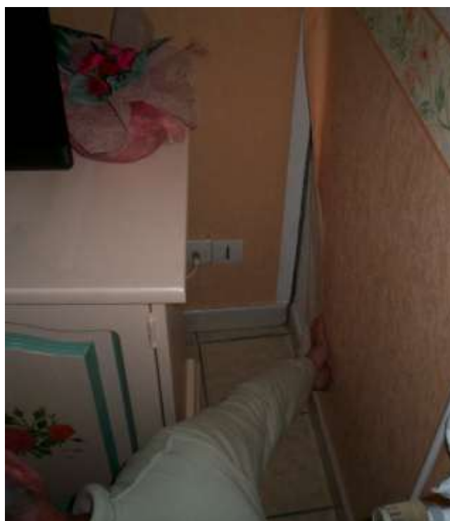
Figure 20 : Vue de l'intérieur de la fissure de la Figure 18c. Le mur de la fenêtre à droite du cliché, correspondant aux vues 18a et 18b montre également des fissures traversantes.
