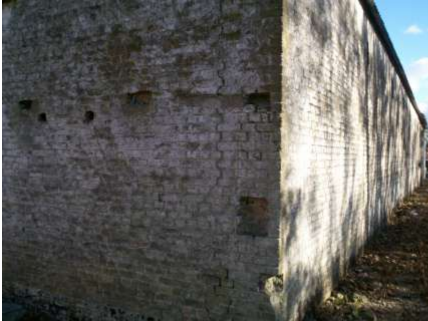
Figure 14 : Fissure dans le mur ouest de la Grange 3
