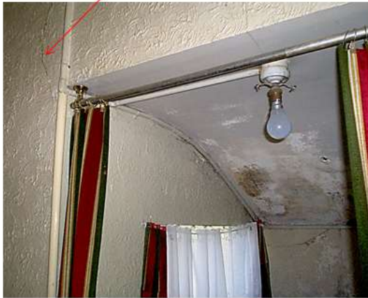
Fissure traversante du mur de la façade nord
