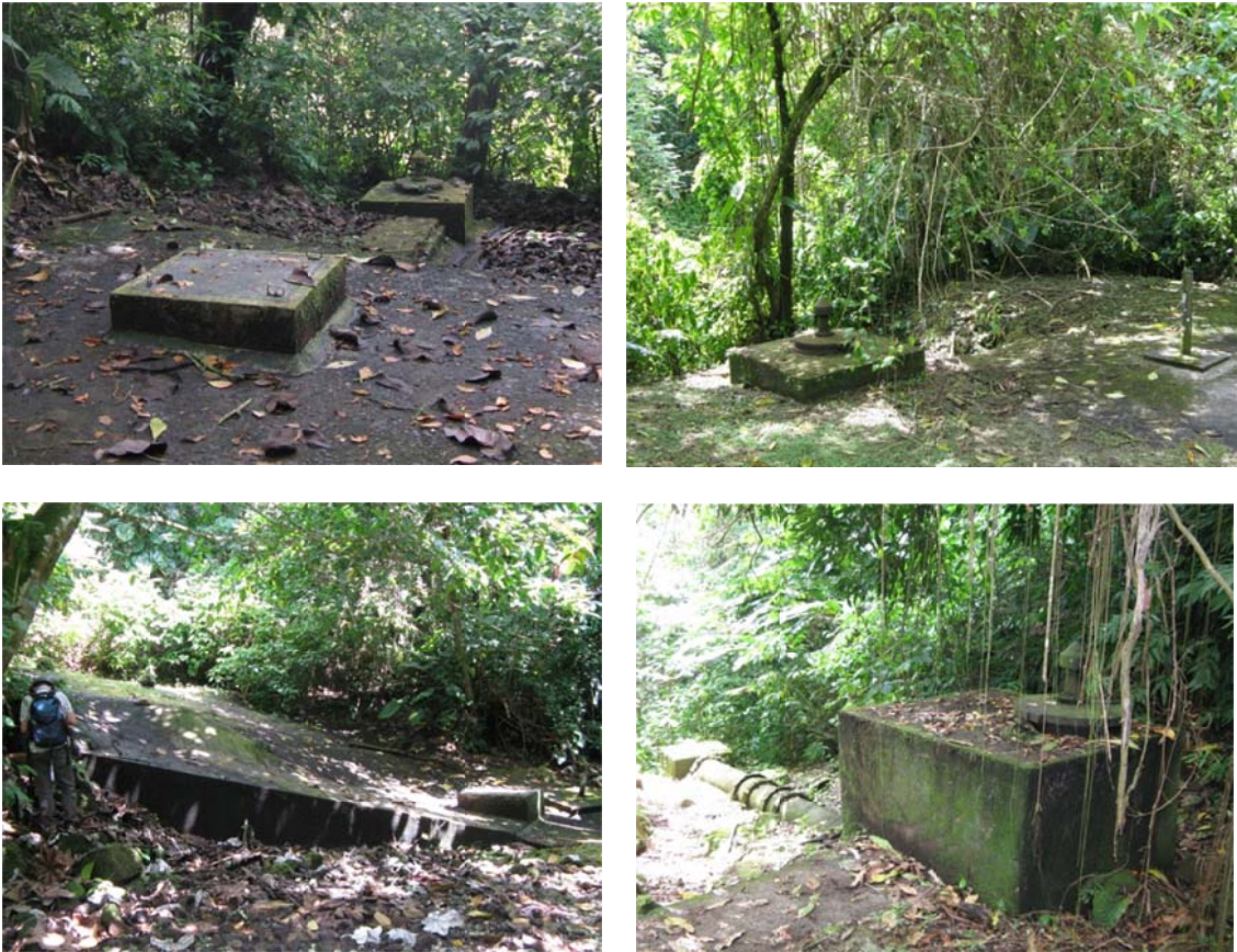
Illustration 7 : photos des captages des sources 2 (1159ZZ0054), 5 (1159ZZ0013) - aval et amont - et 6 (1159ZZ0057) de Belle-Eau-Cadeau – 19/04/2011
