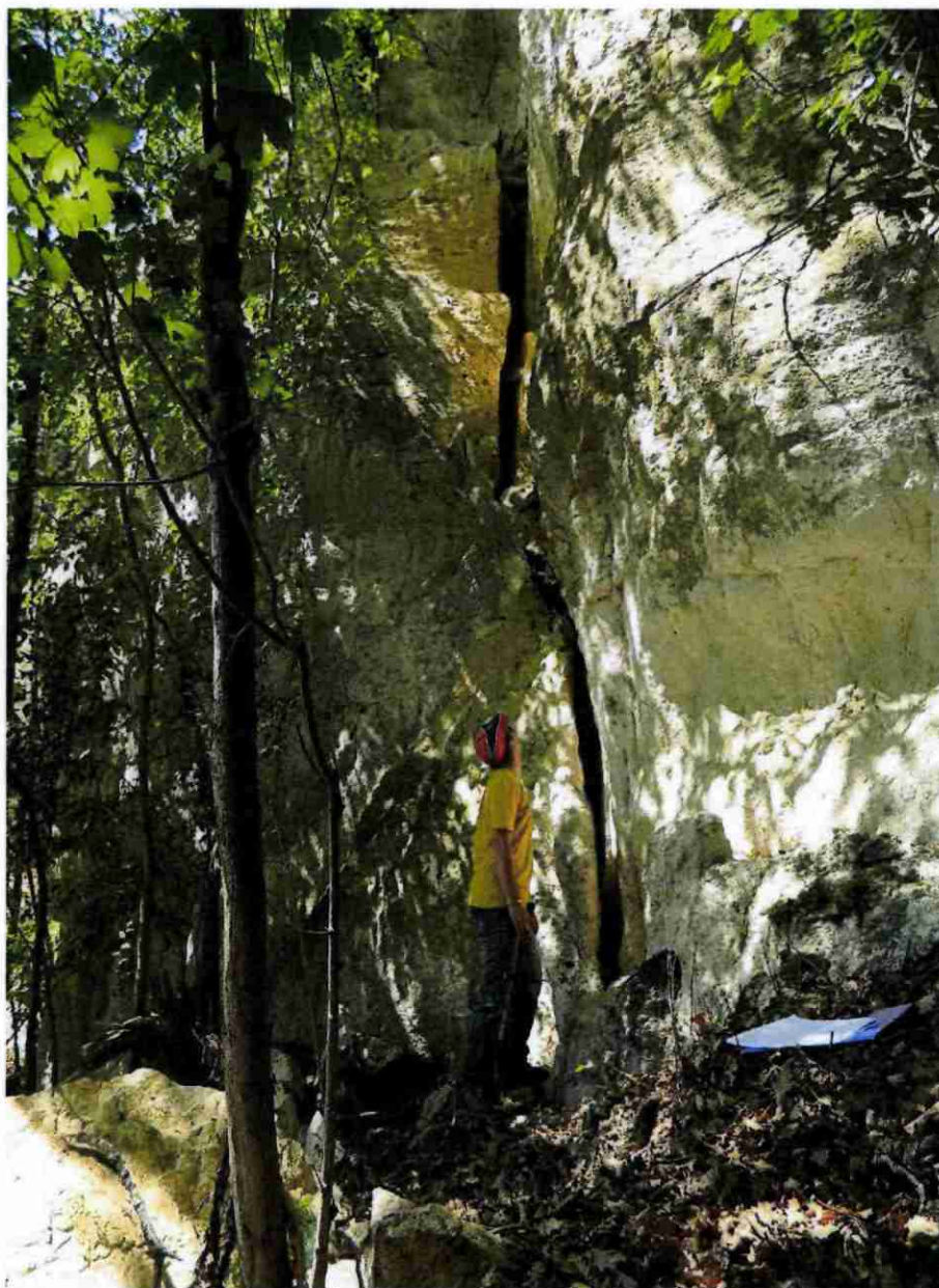
Illustration 33 : Colonne de falaise du Vallon de Vérone (Foulayronnes) qui menace de s'ébouler par basculement en tête
