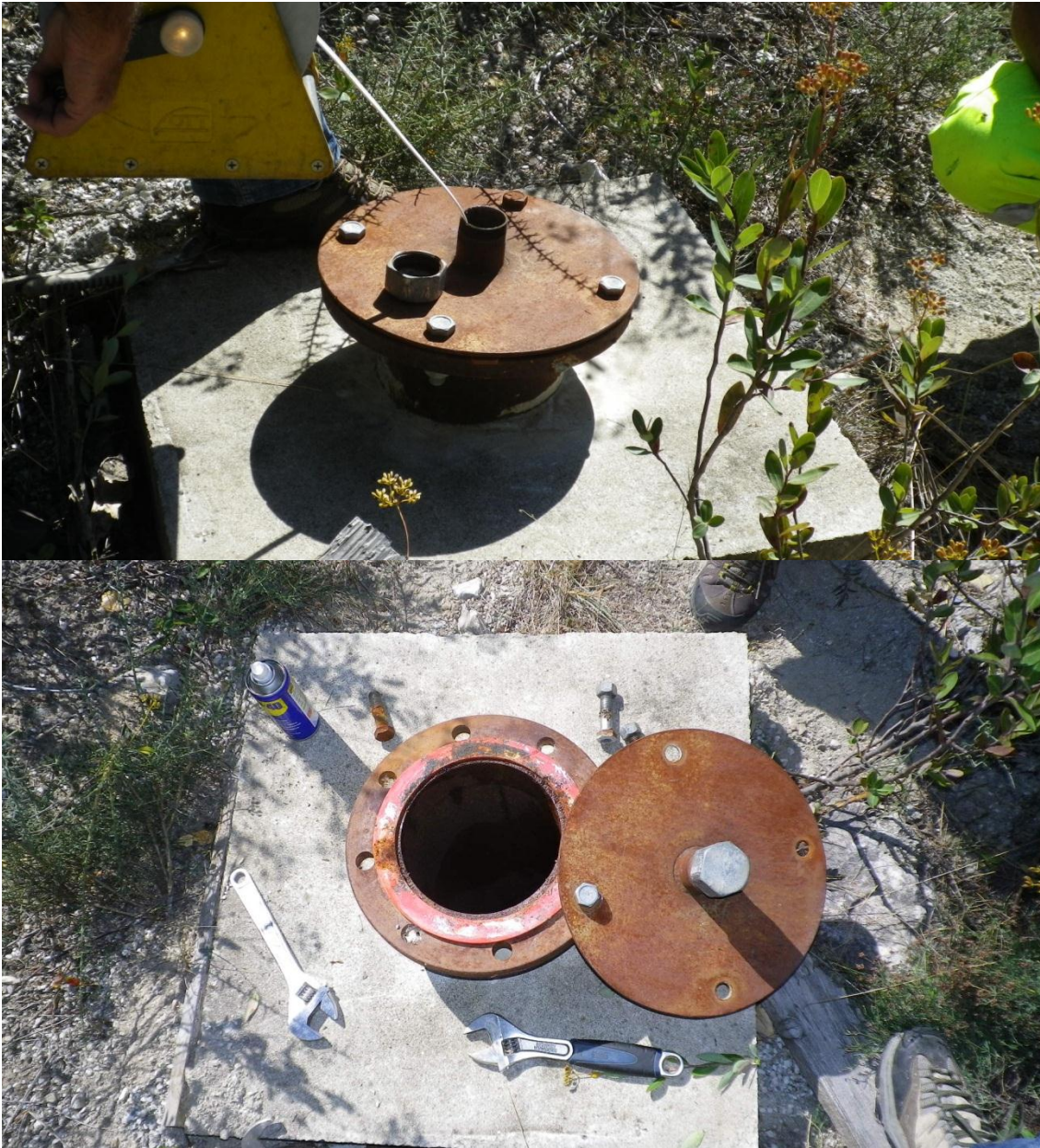
Illustration 7 : Vue du forage F5 de Sournia, fermé et ouvert.
