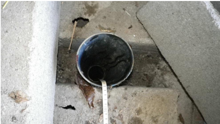
Illustration 3 : Vues de la tête de tubage et de la pompe installée dans le forage de M. Lasne.
