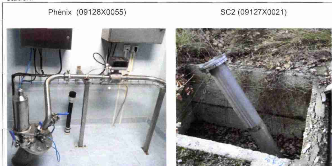
Illustration 20 : Photos des têtes des forages Phénix et SC2.
