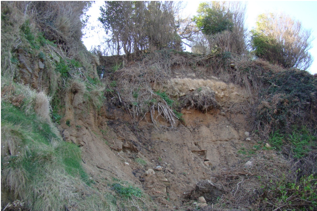
Photo 1 : Vue du glissement
