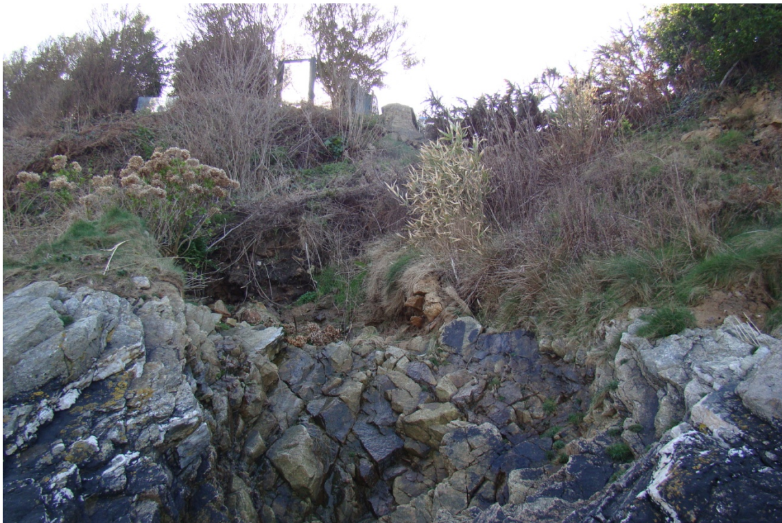
Photo 4 : Entonnoir créé dans une zone de forte fracturation du granite
