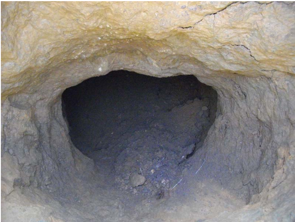
Photo 2 : Fond de l'effondrement avec orientation vers le sud-est en profondeur.
