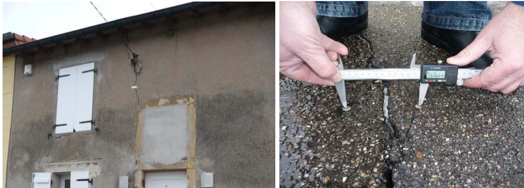
Illustration 96 - Un fissuromètre installé en façade - Surveillance d'une fissure de chaussée commune d'Angevillers (57).
