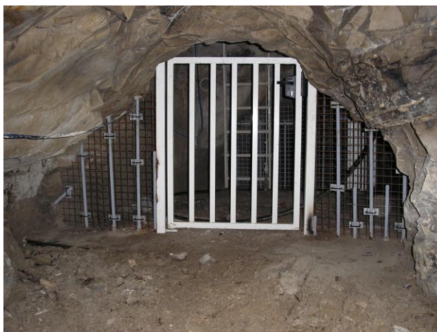
Illustration 186 - Portillon de sécurité dans la mine Les Camoins à Marseille (13).
