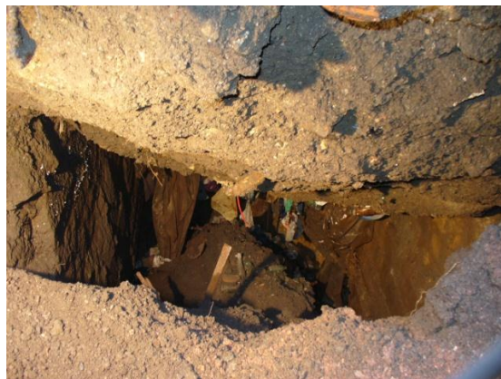
Illustration 163 - Habitation 7 rue de la chapelle : Vue du tassement des remblais du puits, La Machine (58).
