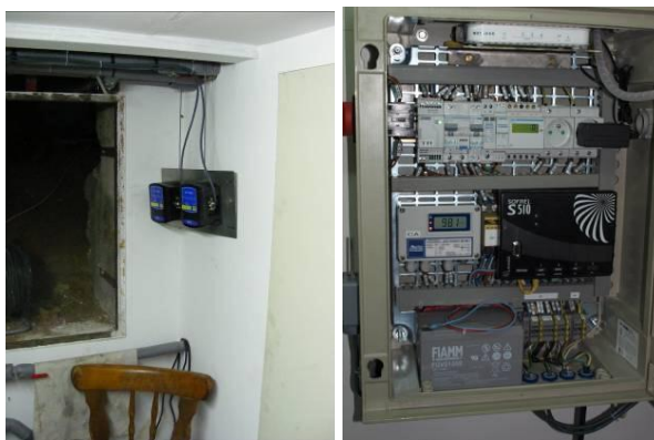
Illustration 90 - Capteurs à l'entrée du vide-sanitaire - armoire de liaison, habitation impasse des merles à Cocheren (57).
