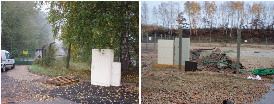
Illustration 203 - Puits Simon 5 : Coffret d'alimentation à l'entrée du site - boîtier au niveau du puits, concession De Wendel, Stiring-Wendel (57).
