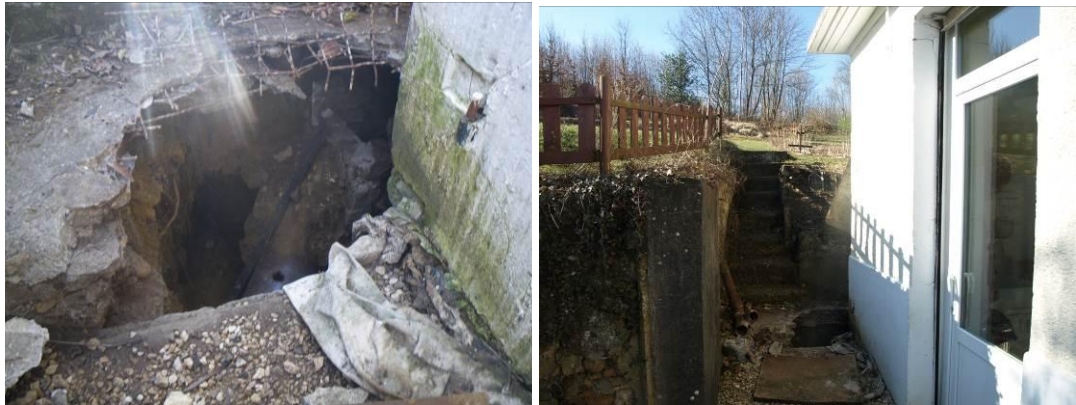
Illustration 201 - Le fontis au coin de la maison - L'accès difficile à la zone à traiter, 97 rue de Villers à Vandoeuvre-les-Nancy (54).
