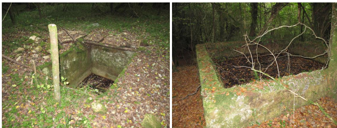
Illustration 144 - « Le Bas Vallon » - Infrastructures béton (avant travaux) à L'Hermitage-Lorge (22).
