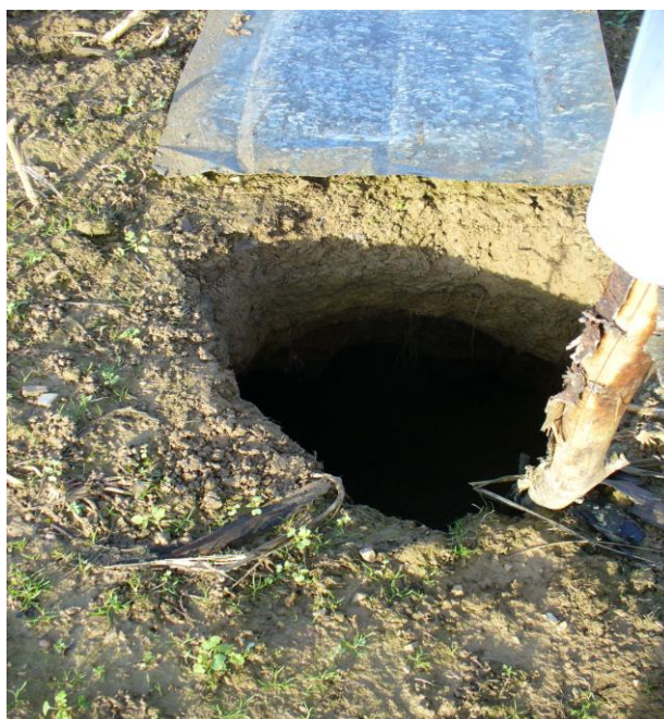
Illustration 176 - Vue du fontis avant travaux, Saint-Erblon (53).
