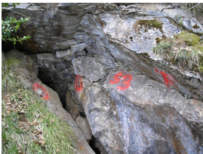
Illustration 58 - Surveillance des fractures existantes sur le site du Rancié (09).
