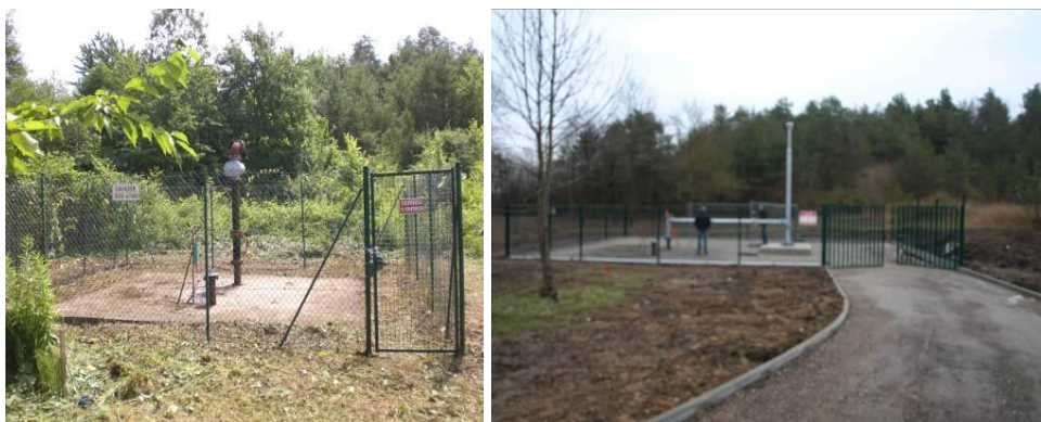
Illustration 130 - Puits 4 à Preusdorf (67) : Dispositifs la tête, ancien – nouveau.
