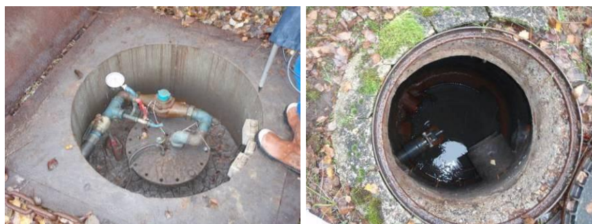
Illustration 233 - Forage Gazomètre Aval, regards : Pompage – Prélèvement, Morsbach (57).
