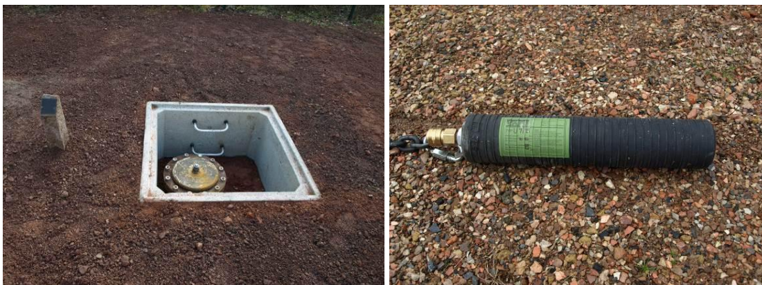
Illustration 208 - Puits 2 (Jules) : Regard aménagé – Vue du packer posé dans le puits Ouest, La Houve.
