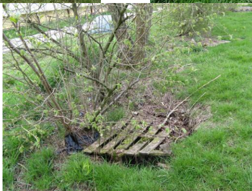
Illustration 21 - Effondrements de marnières au lieu-dit Bourdigal, sur la commune de Montreuil-le-Henri (photographie BRGM)
