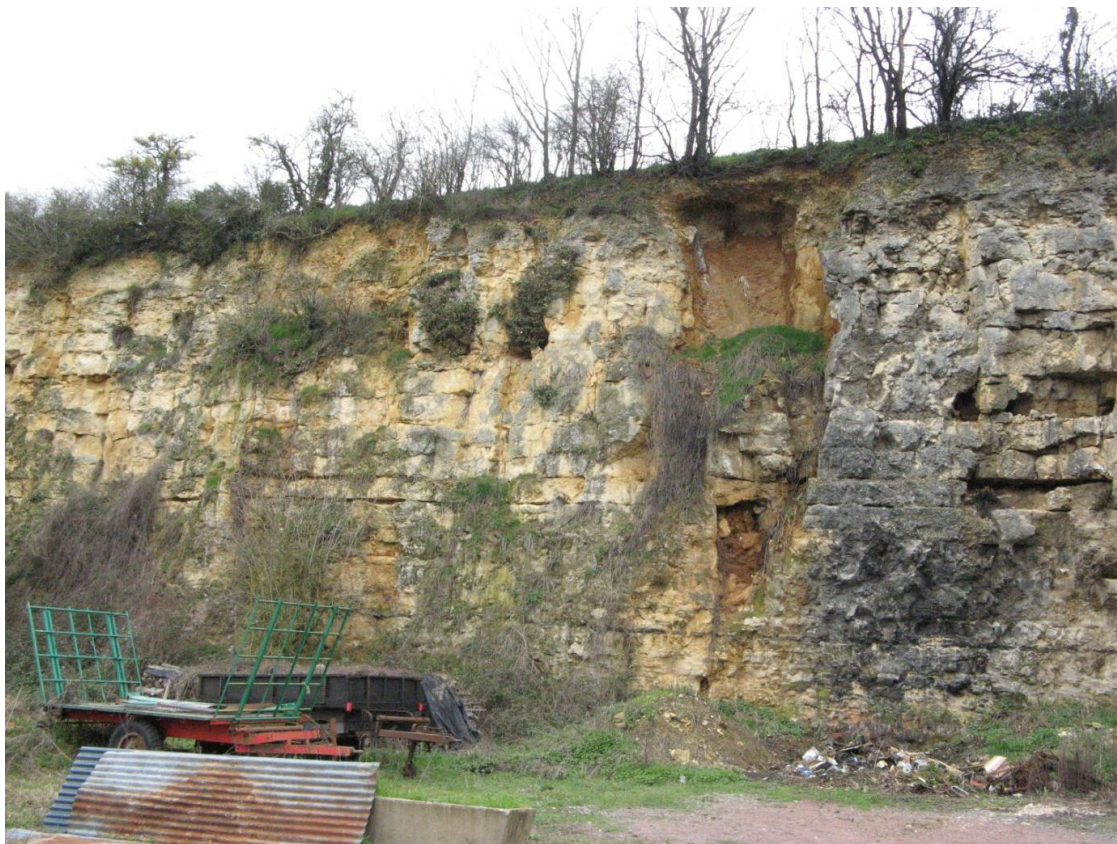
Illustration 25 – Chutes de blocs survenues sur la commune d’Avoise (photo BRGM, 2011)
