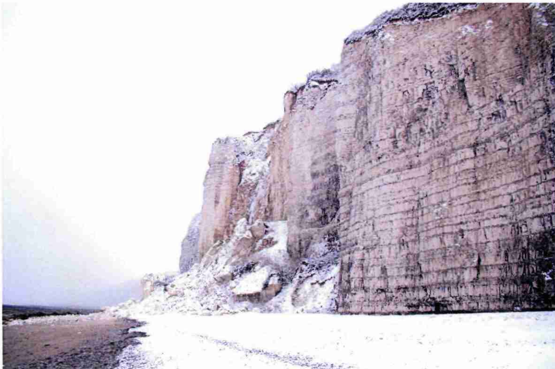
Photo 4 : Restes visibles de l'éboulement de 2006.
