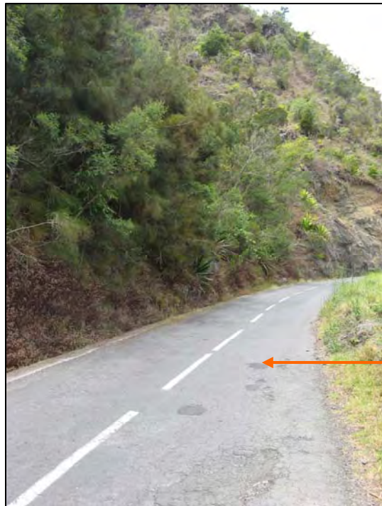
Impacts de chute de blocs
