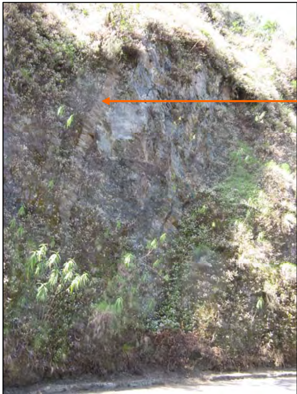
Talus en rive gauche de la ravine
