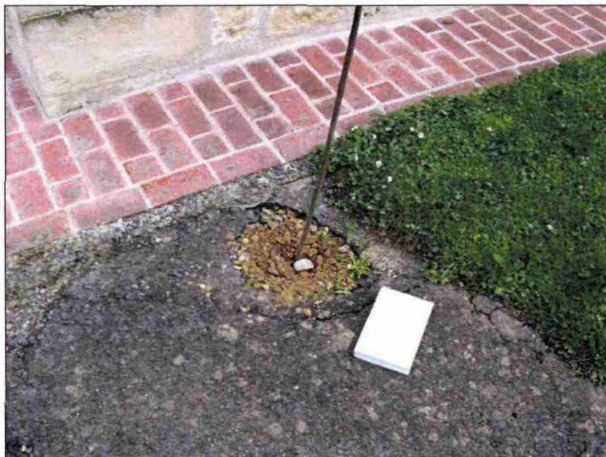
Illustration 5 – Affaissement affectant le trottoir (source : BRGM)
