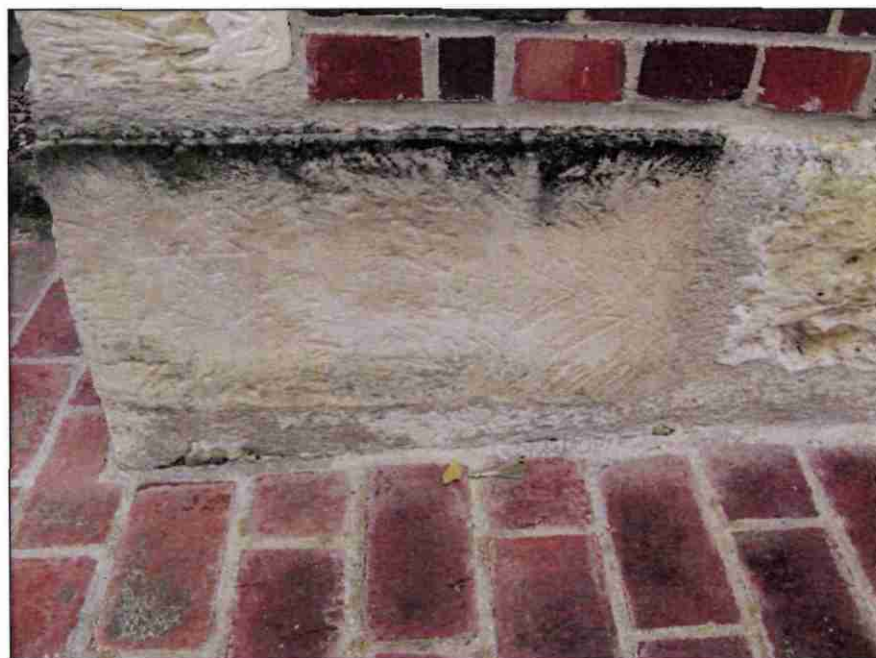
Illustration 6 – Mur et trottoir de la maison du 263 rue Pennellier (source : BRGM)
