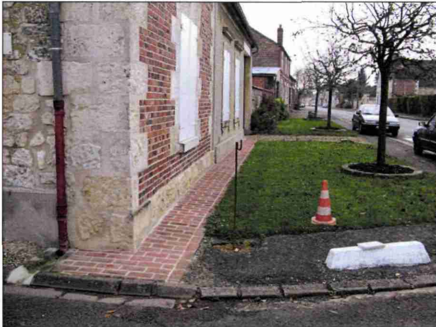
Illustration 4 – Affaissement affectant le trottoir et maison du 263 rue Pennellier (source : BRGM)
