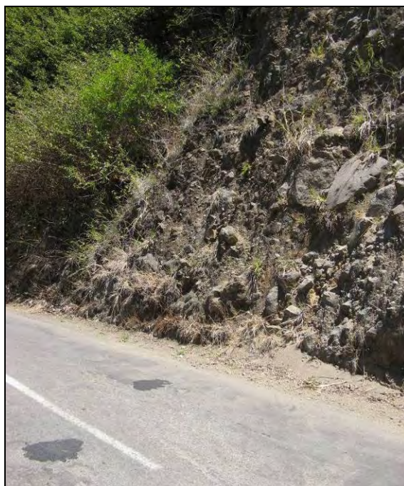
Figure 25 : Impacts de chute de blocs sur la chaussée
