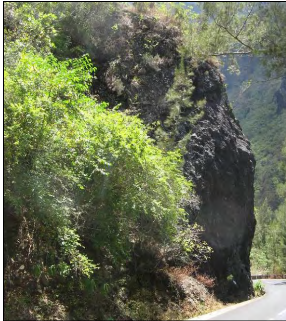
Figure 16 : Mégablocs d'avalanche de débris, PR 4 + 400
