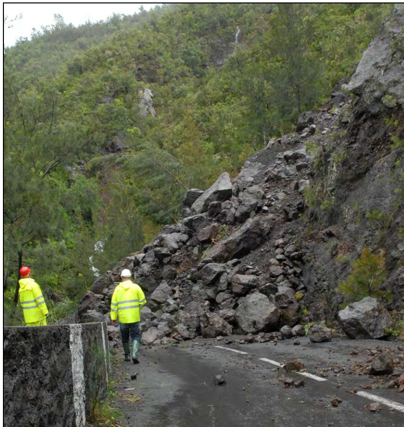
Figure 26 : Eboulement obstruant la RD242 vers le PR 2+400, à l'occasion du passage de Gamède en 2007
