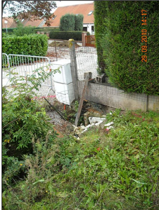
Figure 7 : Vue de l'effondrement, prise de l'entrée de la maison en direction du nord-est
