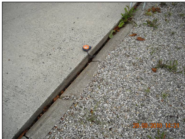
Figure 8 : Décalage trottoir / voirie
