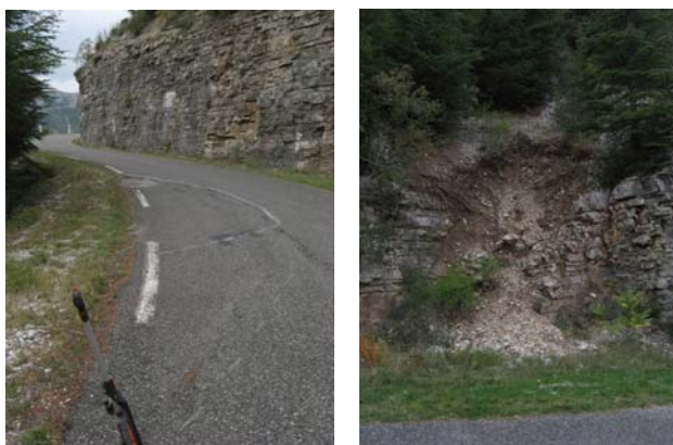
illustration 46 – PR3+040, franchissement d'un couloir d'éboulis et affaissement en rive
