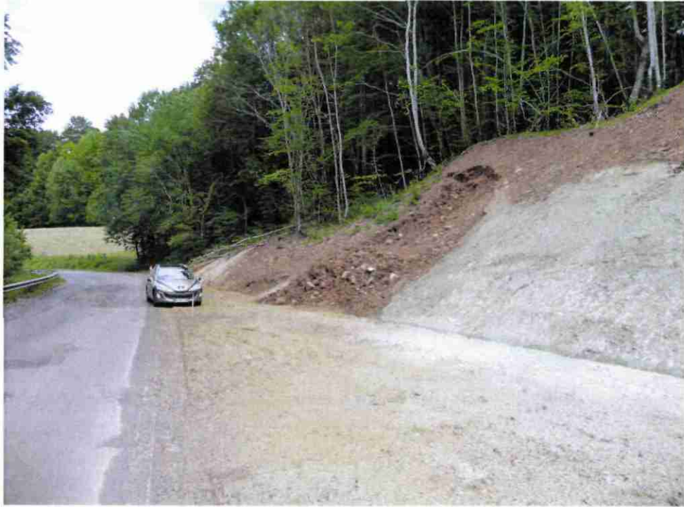
Illustration 9 - Glissement superficiel dans les argiles vertes de l'Oligocène dans un talus de déblai de la RD 600 (photo BRGM, juillet 2010)
