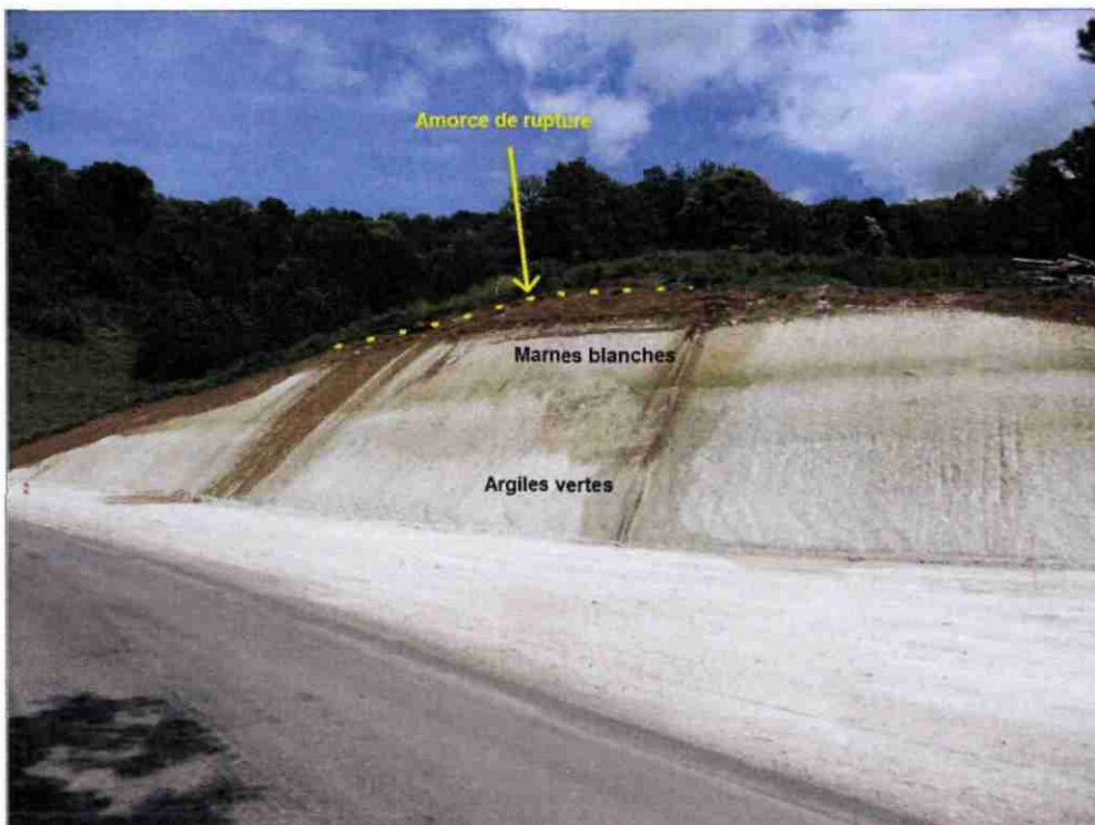
Illustration 10 - Amorce de rupture dans le talus fraîchement ouvert en vue de l'élargissement de la RD 600 (photo BRGM, juillet 2010)
