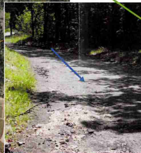
Ruissellement et dégâts causés sur la route
