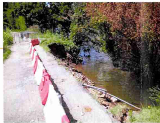
Effondrement d'une berge du Lot
