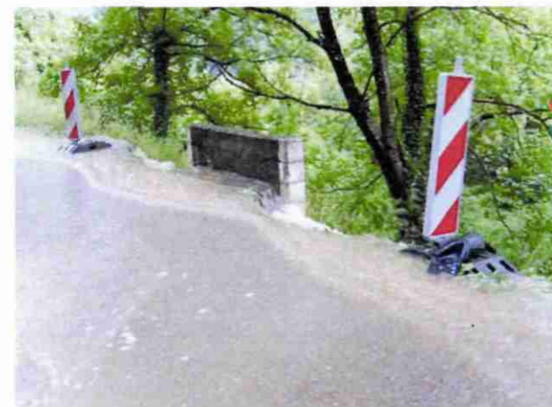
Photo n°1 : Inondation par la source de font d'Egre et dégâts causés sur le bord de route
