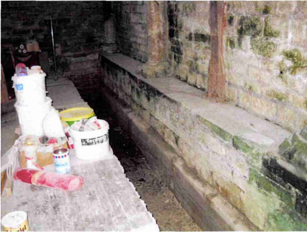
Illustration 7 – Fossé de drainage situé dans une salle de l'église de Catus.
