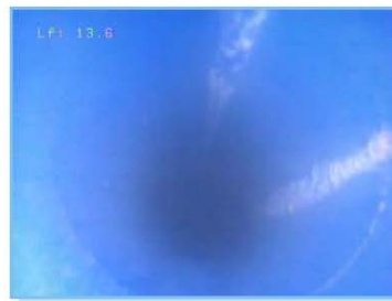
Tube en PVC - diamètre 180 mm coulures de ciment au droit d'un raccord
