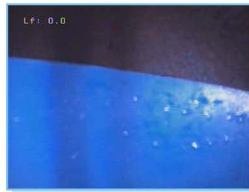
Sommet du tube plein en PVC diamètre 180 mm
