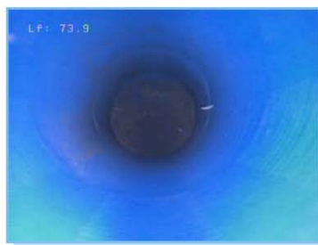
Base de l'ouvrage recouverte de sédiments meubles
