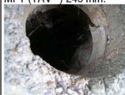
Cavité formée suite aux éboulements dans le trou
