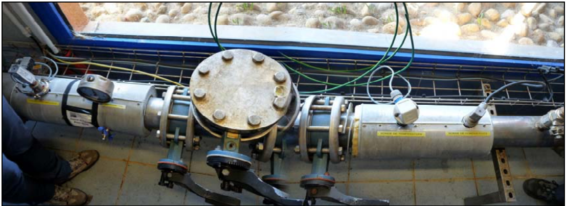
Illustration 25 : Instrumentation de suivi (sondes) sur la colonne d'exhaure du forage Yvroux
