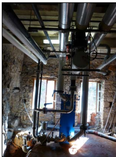
Illustration 15 : Echangeur pour le réchauffage du fluide thermal
