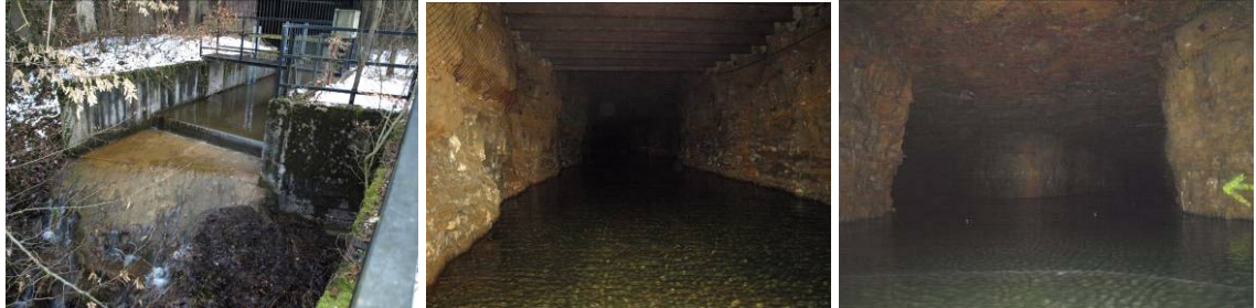
Illustration 15 - Déversement dans le Conroy – La galerie d'accès - Le carrefour.
