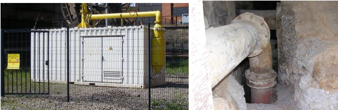
Illustration 74 - Bungalow de Simon 5 et branchement dans la chambre à vannes de Simon 1.
