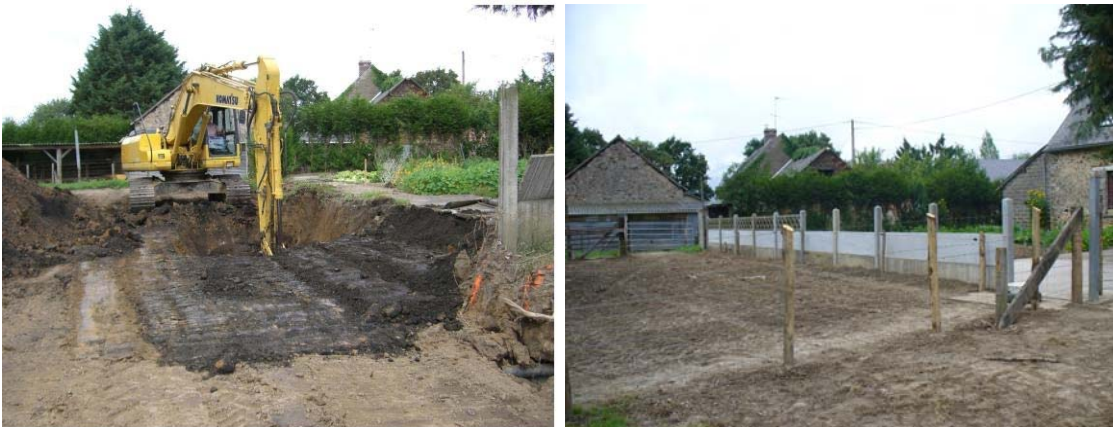
Illustration 102 - Traitement de la galerie Saint-Isle. Vue de la galerie avec des vestiges de boisage. Vue pendant et après les travaux – La Baconnière (53).
