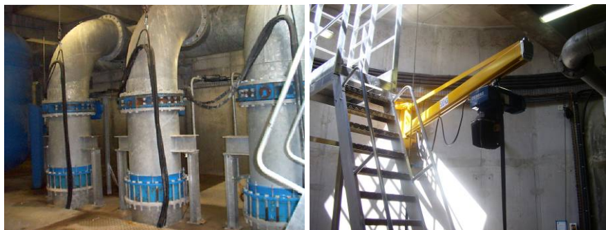
Illustration 24 - L'intérieur de la station Weihergraben – Le bras de manutention installé.
