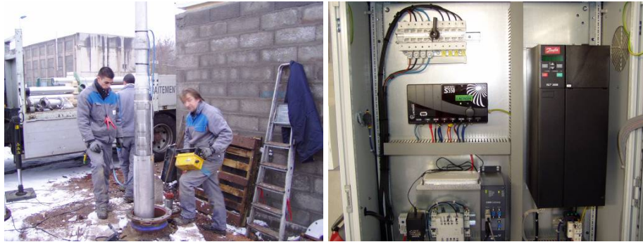
Illustration 123 - Mise en place de la pompe - Installations de télégestion et d'automatisation.
