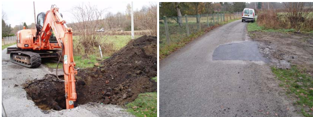
Illustration 96 - Excavation du fontis sur la route à Saint-Martial-le-Mont (23). Réfection de la route après travaux.
