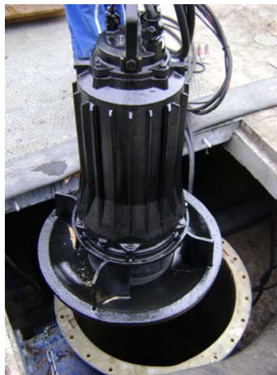
Illustration 4 - Station de relevage LEMAY à Pequencourt (59) - Remplacement d'une pompe de 950 m 3 /h.
