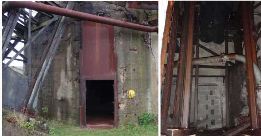
Illustration 118 - Puits Vuillemin 2 : dispositif de manœuvre de la porte et étiayage sous les cages.
