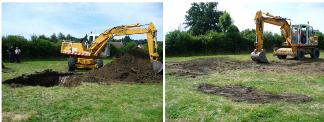
Illustration 94 - Traitement d'un fontis à Lavaveix (23).
