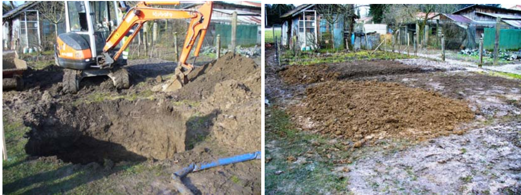
Illustration 95 - Excavation du fontis dans le jardin à Beaune-les-Mines (87) et vue après travaux.
