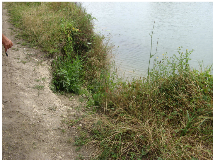
Illustration 25 - Erosion de berge, commune de Chaniers (17)
