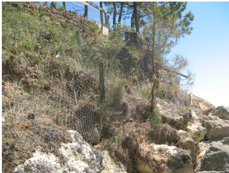
Illustration 18 - Glissement de terrain, Commune de Meschers-sur-Gironde (17)
