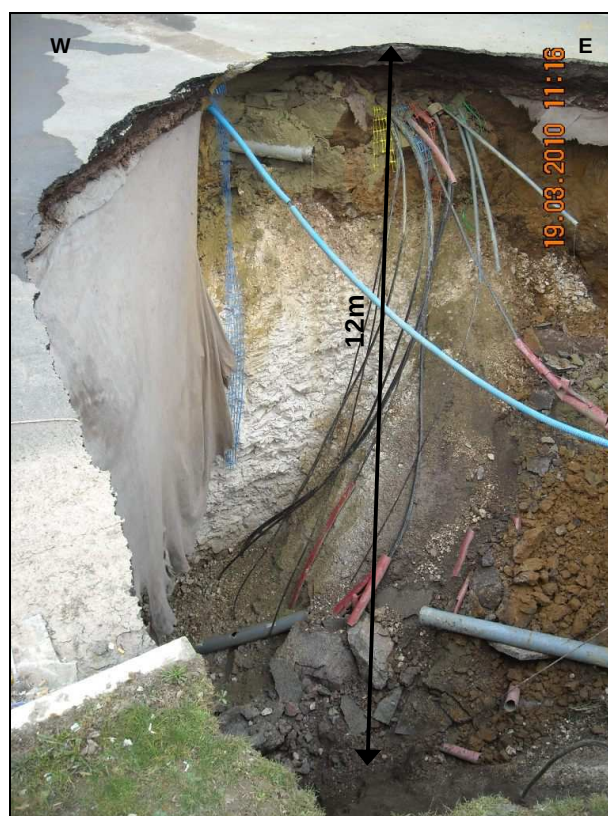
Figure 9 : vue de la paroi nord de l'effondrement
