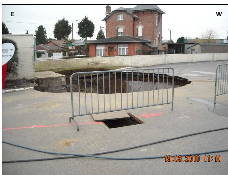
Figure 7 : Vue générale de l'effondrement en direction du sud
