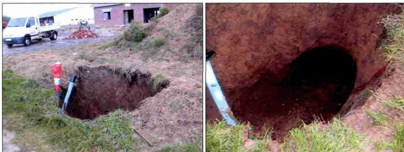
Photo 9 : Effondrement survenu en 2007 au 23, rue de la Chapelle (clichés de M.Chevin)
