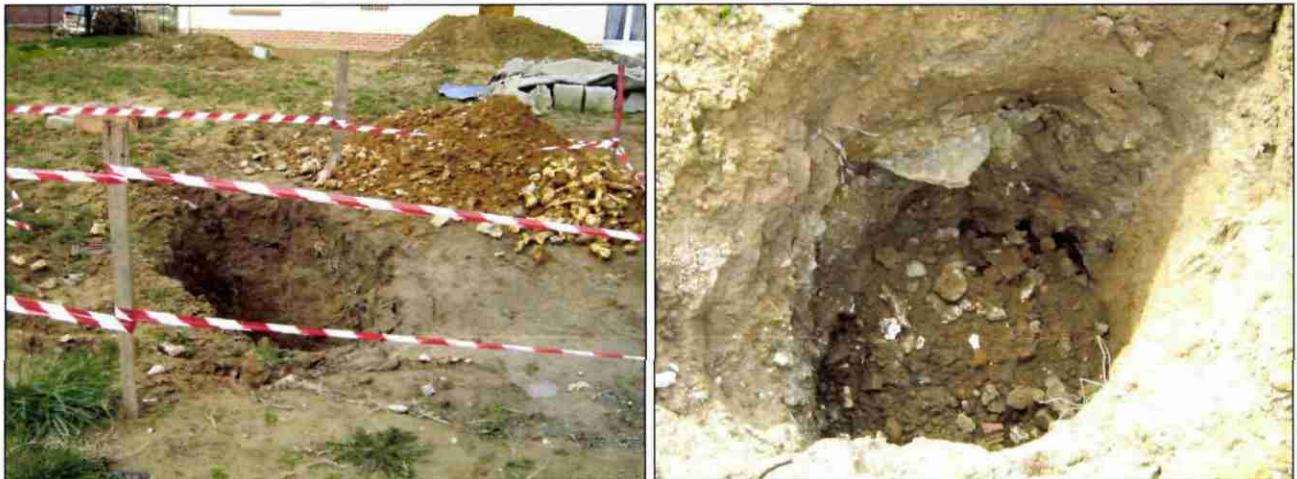
Photo 8 : Effondrement rue de la Chapelle
