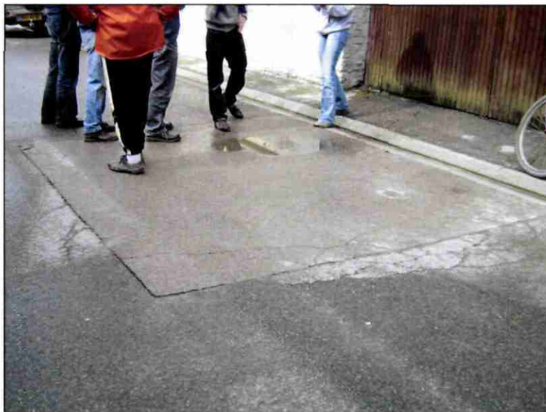
Photo 7 : Affaissement au 6, rue Blanche
