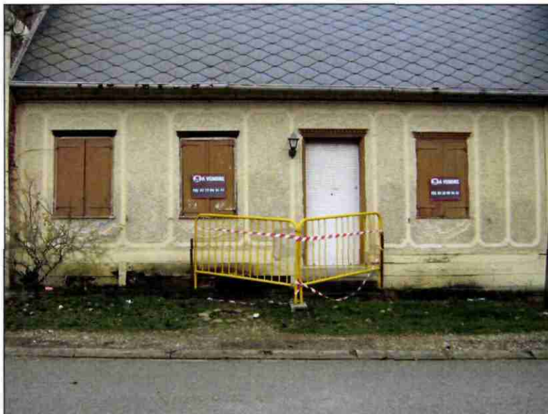
Photo 1 : Effondrement visible depuis la rue Gaston Blanchard
