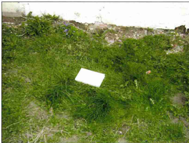
Photo 5 : Affaissement dans la cour intérieure
