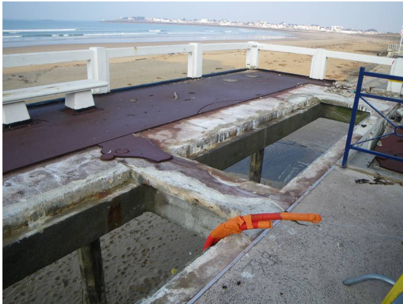
Figure 15 : Dommage sur ouvrage de front de mer.
