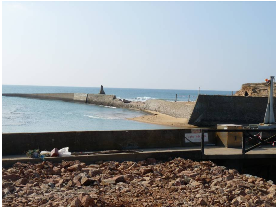
Figure 14 : Endommagement de la jetée et de l'écluse de la Gachère (au sud de Brétignolles-sur-Mer) dû à l'action des vagues
