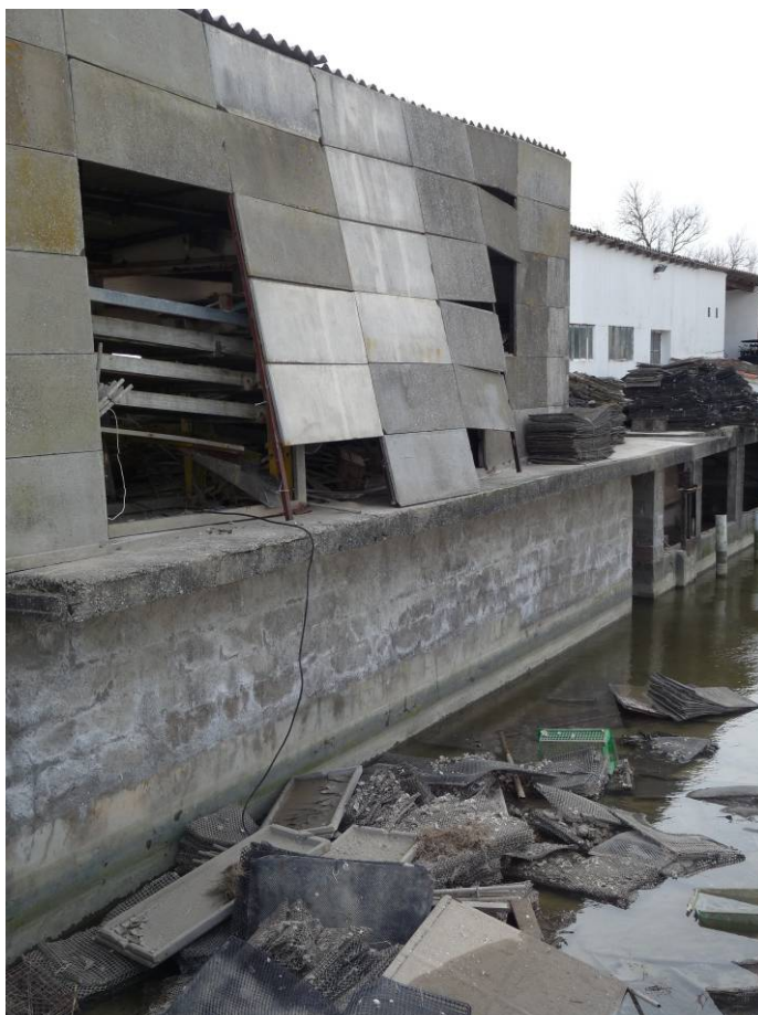
Figure 27: Exemple de dégâts sur des exploitations ostréicoles (Boucholeurs au sud de Châtaillon-Plage)
