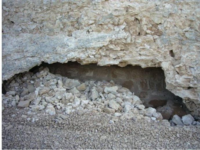
Figure 13 : Endommagement (formation de renards hydrauliques) de la digue de l'Aiguillon-sur-Mer
