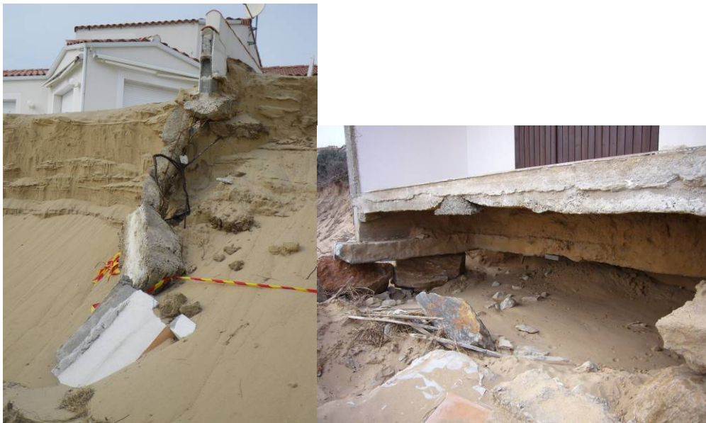
Endommagements sur les maisons en première ligne dus à l'érosion liée à l'action des vagues. Affouillement du terrain naturel sableux et déstabilisation des maçonneries, affouillement sous les fondations (La Tranche-sur-Mer).
