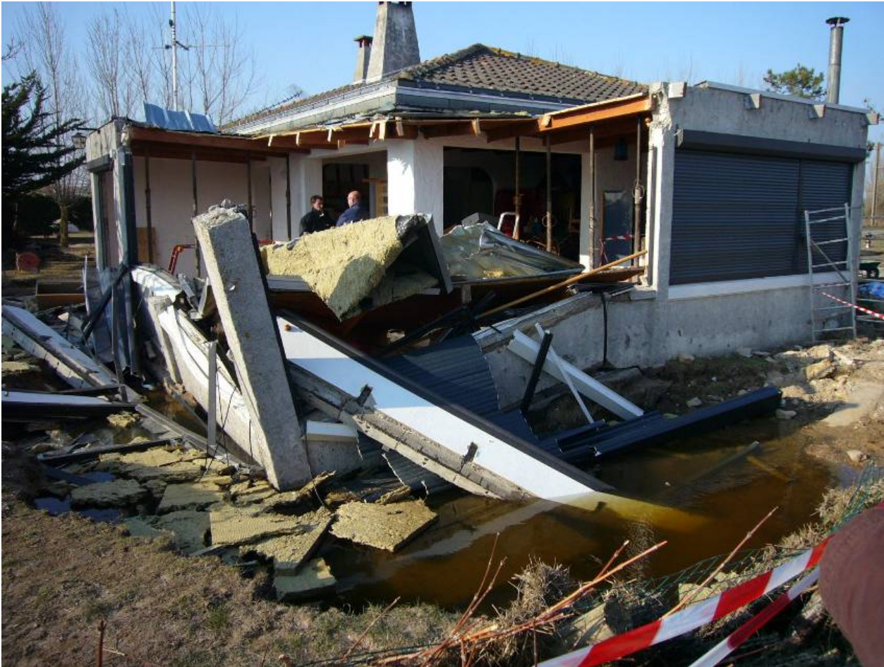
Figure 24 : Effondrement partiel d'une maison
