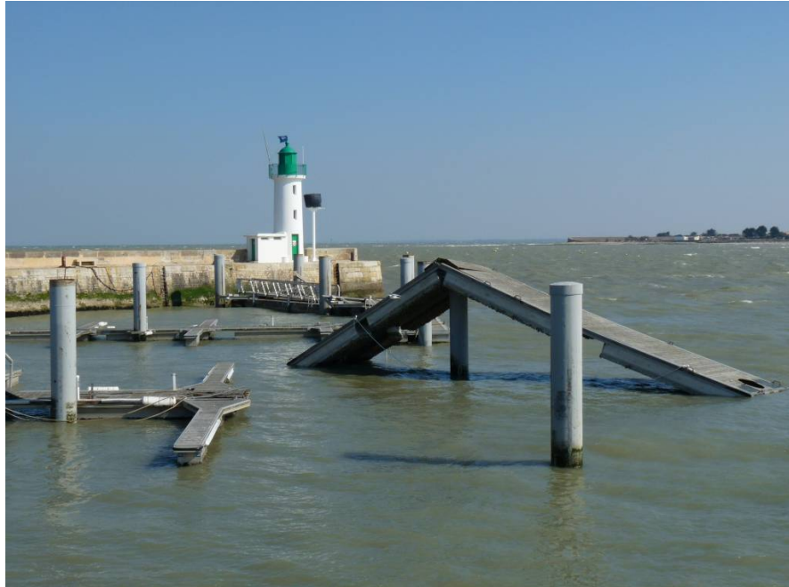
Figure 17: Dommages sur des structures portuaires (île de Ré, port de La Flotte).
