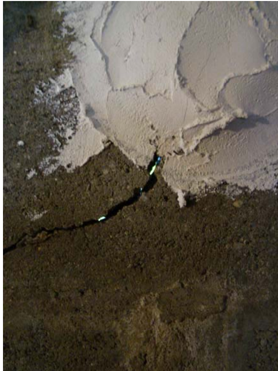
Photo 11 : Lézarde laissant voir l'extérieur ; témoin fissuré.
