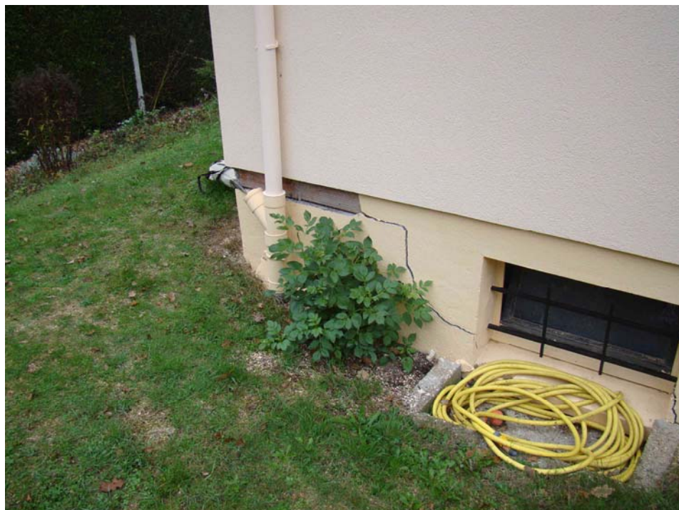
Photo 2 : Fissures pignon ouest.
