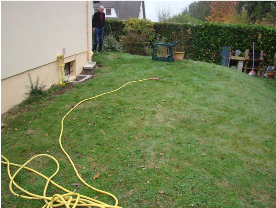
Photo 7 : Même fissure, circulaire, matérialisée par le tuyau d'arrosage.
