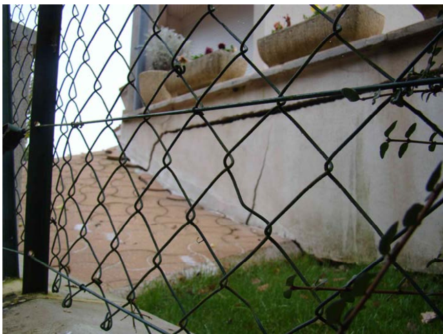
Photo 17 : Fissures observées au 35, rue de la cote blanche.
