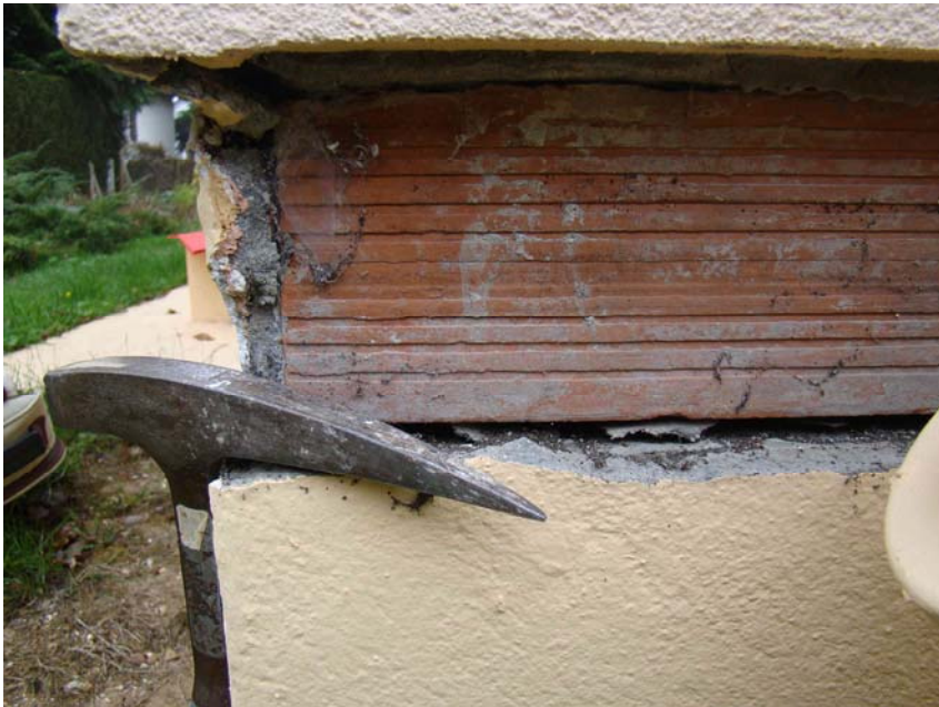
Photo 3 : Ouverture d'une fissure, pignon ouest.
