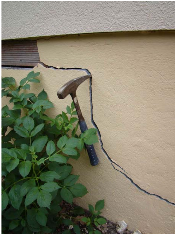
Photo 4 : Fissure oblique ouverte, pignon ouest.
