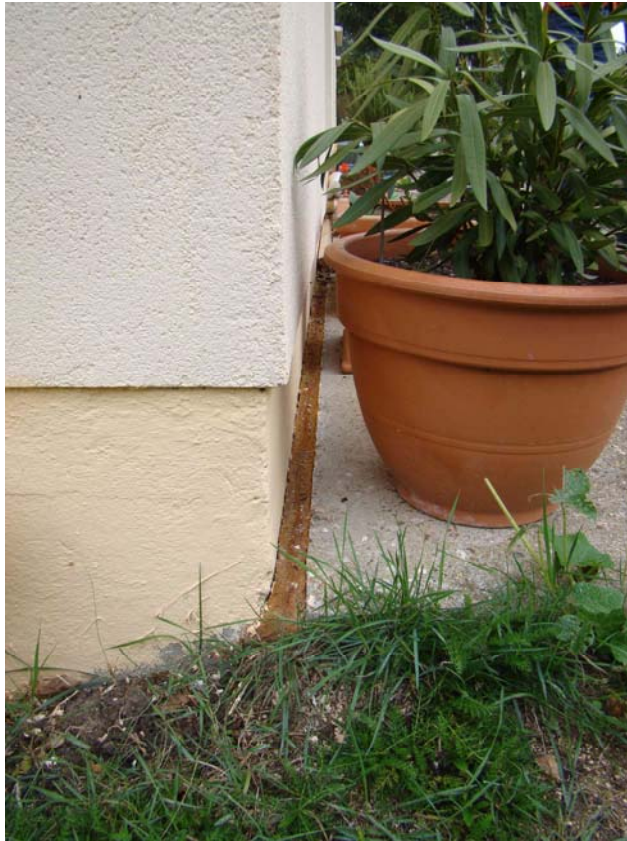
Photo 15 : Sud de la maison ; désolidarisation ancienne entre la terrasse et la maison.
