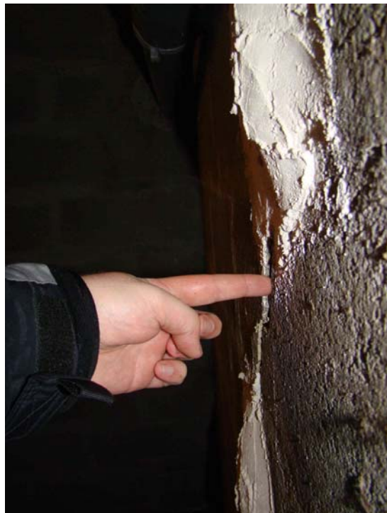
Photo 12 : Fissure oblique admettant un léger décalage.
