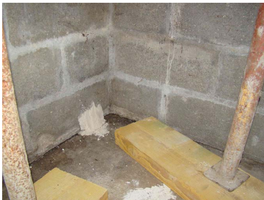
Photo 10 : Angle nord-ouest ; Dalle se désolidarisant du mur.
