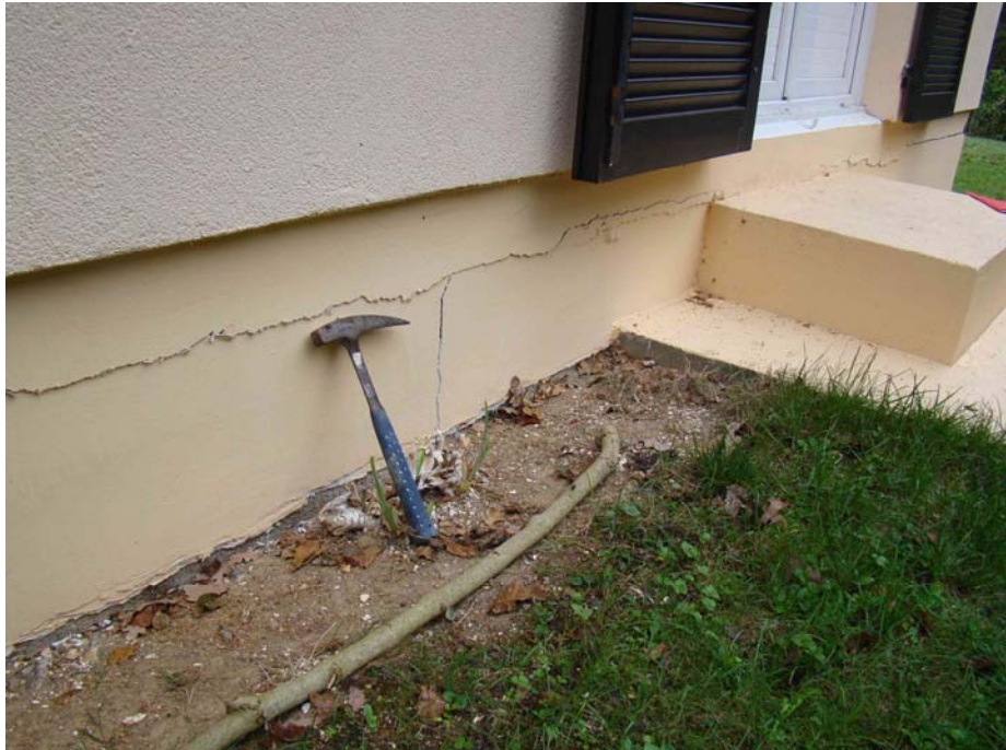
Photo 5 : Fissure, pignon nord
