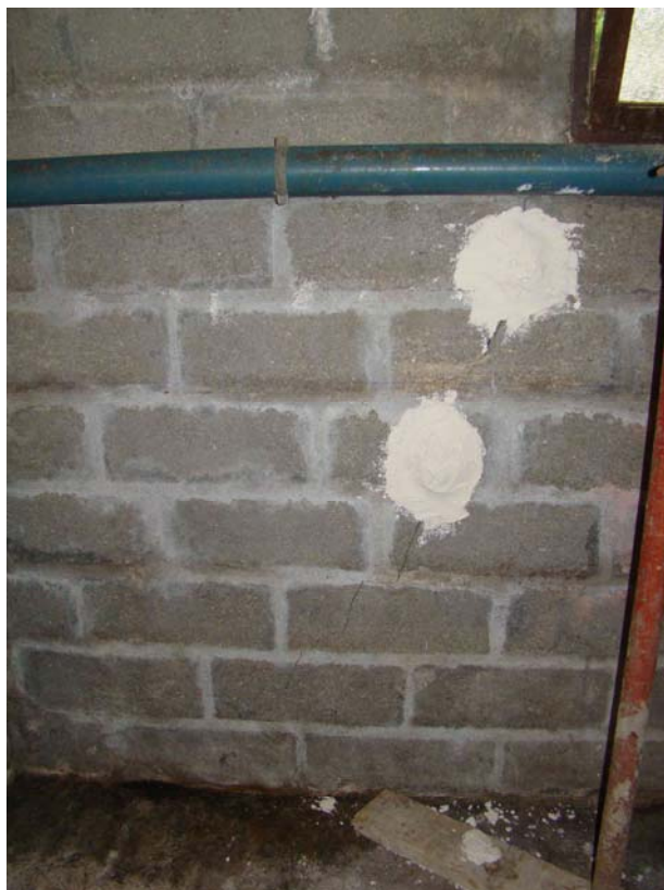
Photo 9 : Fissure oblique traversante.
