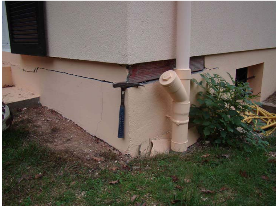
Photo 1 : Fissures angle nord-ouest.
