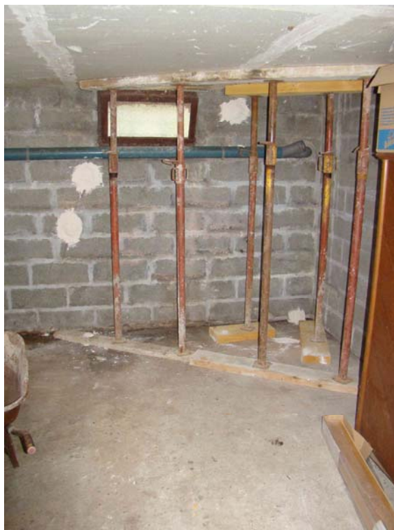
Photo 8 : Angle touché, vu du sous-sol.
