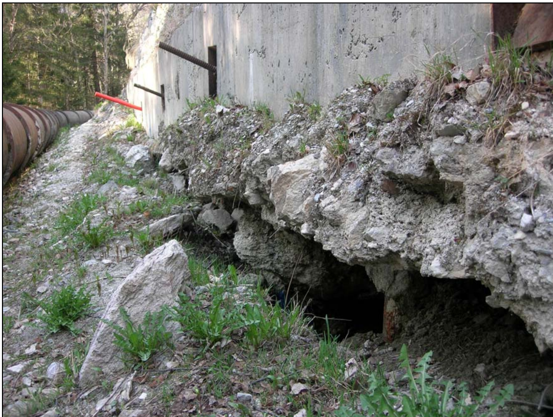
Figure 5 : Mouvements du sol sous la paroi micro-berloise
