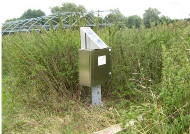
Figure 6 : Station de marque CR2M de Ville-sur-Yron (01632X0070/V105), installée par l'Agence de l'Eau en 2002.
