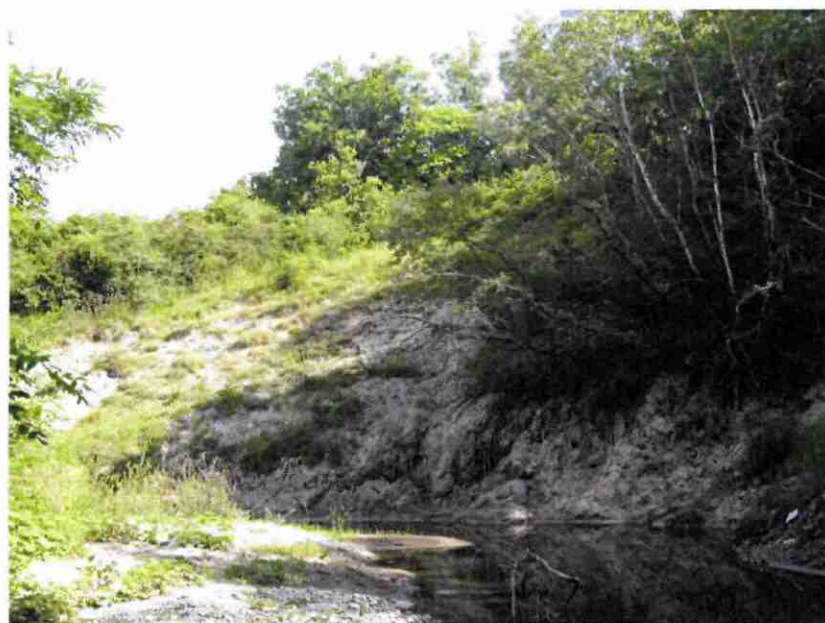
Illustration 23 : érosion de berge au sein de formations glaciaires (photo BRGM).
