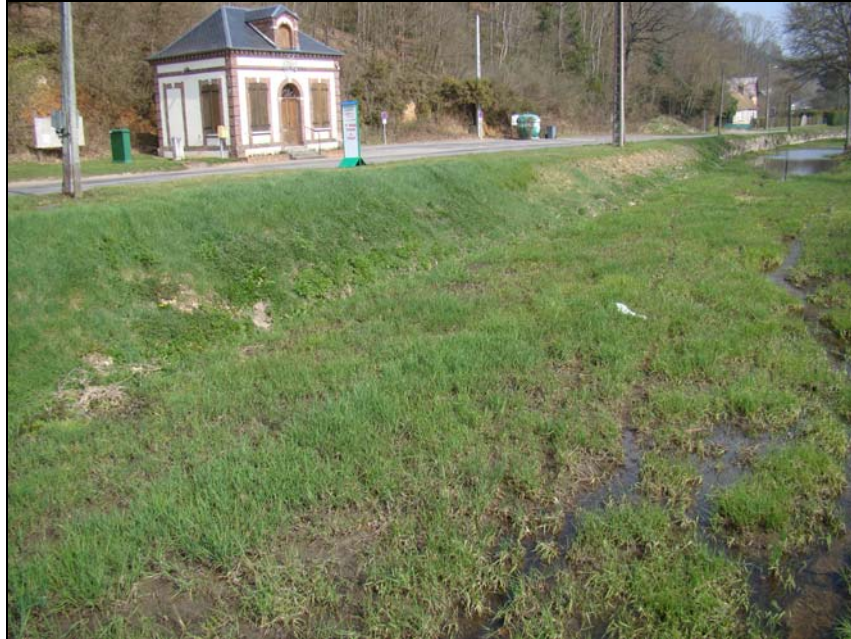
Photo 8 : Prise de vue de l'Iton au niveau du Pont de GAUDREVILLE-LA-RIVIERE. On observe sur cette section un lit limité à quelques chenaux et des vases émergées.
