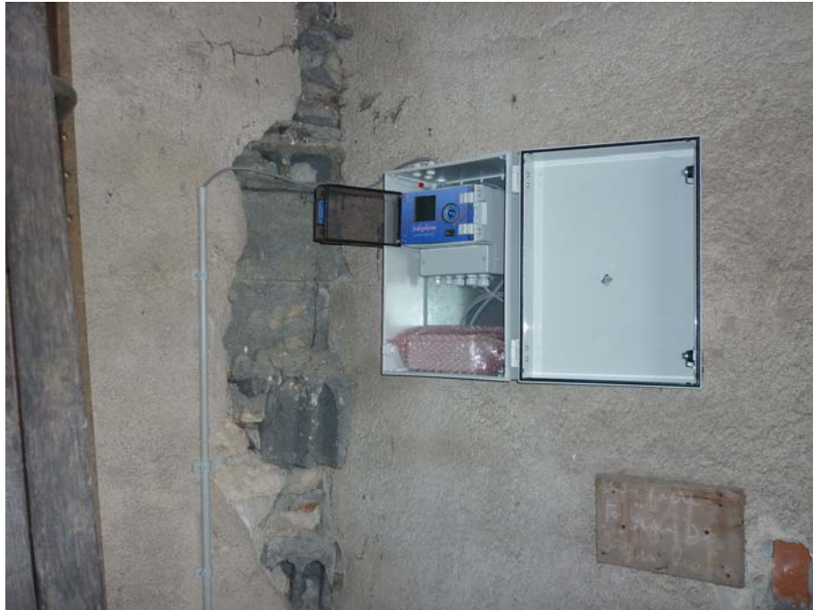
Illustration 23 - Piézomètre du Parc du Moins Roux. Armoire et centrale de mesure.
