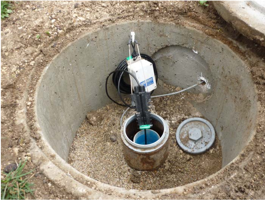
Illustration 21 - Piézomètre de l'Hippodrome. Câble relié à la sonde et à la centrale de mesure.
