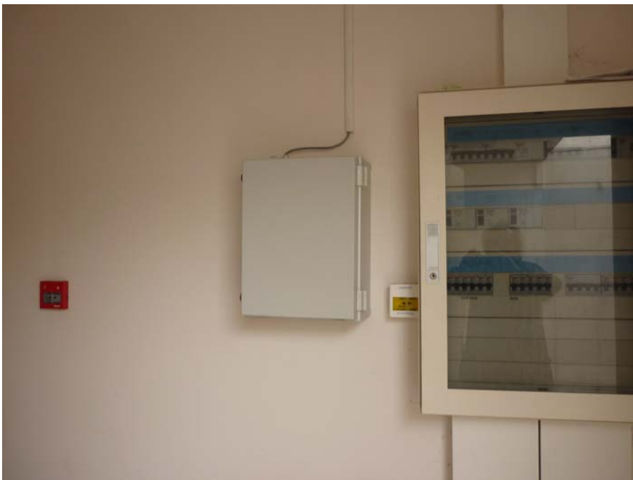
Illustration 22 - Piézomètre de l'Hippodrome. Armoire contenant la centrale de mesure.
