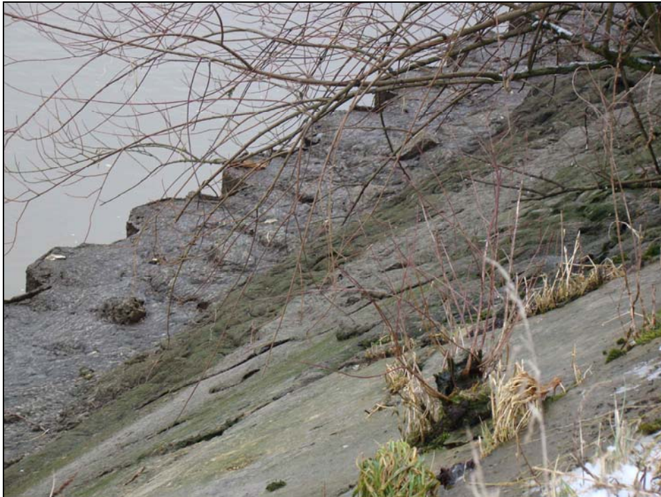
Photo 7 : Végétation et fissuration du perré
