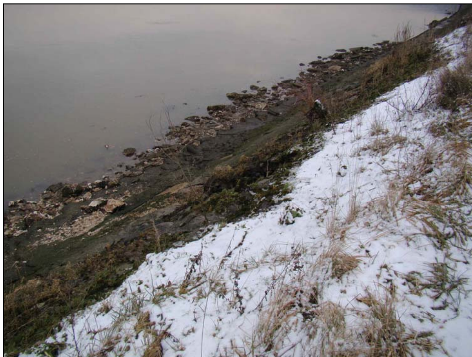
Photo 5 : Début de dégradation du perré.
