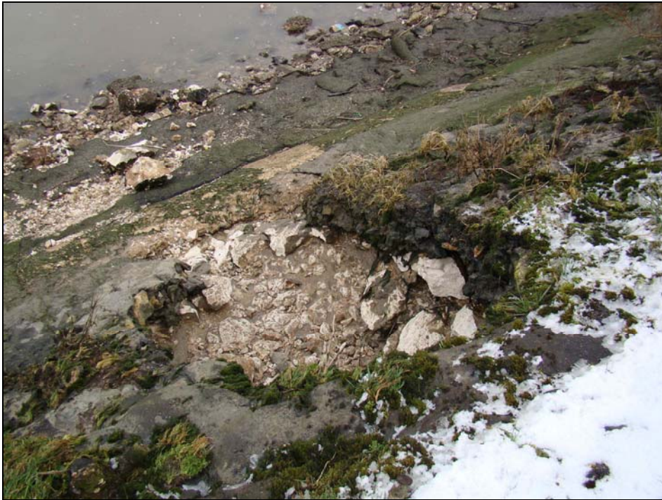
Photo 3 : Vue d'un autre type de désordre observé au bas du perré, laissant apparaître la craie Turonienne.
