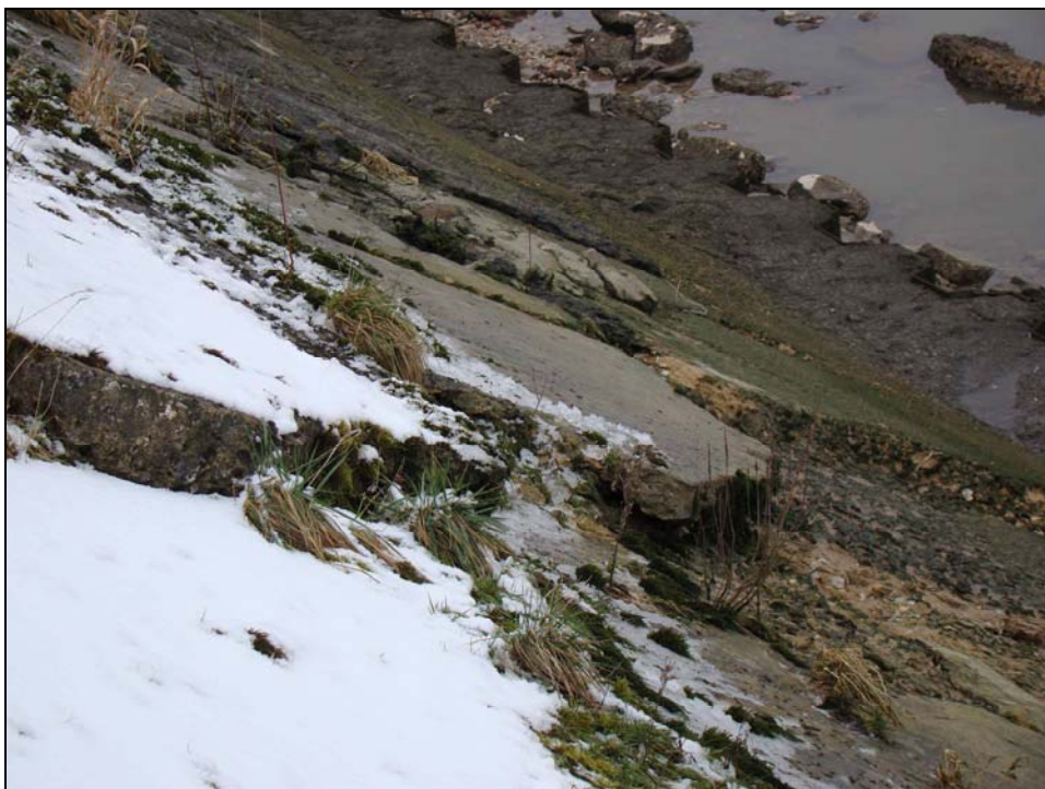
Photo 8 : Erosion se faisant sous des blocs massifs du perré.
