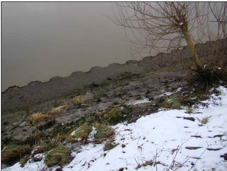
Photo 4 : Type de végétation pouvant affecter le perré.
