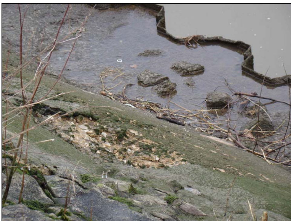
Photo 6 : Autre type de dégradation du perré.
