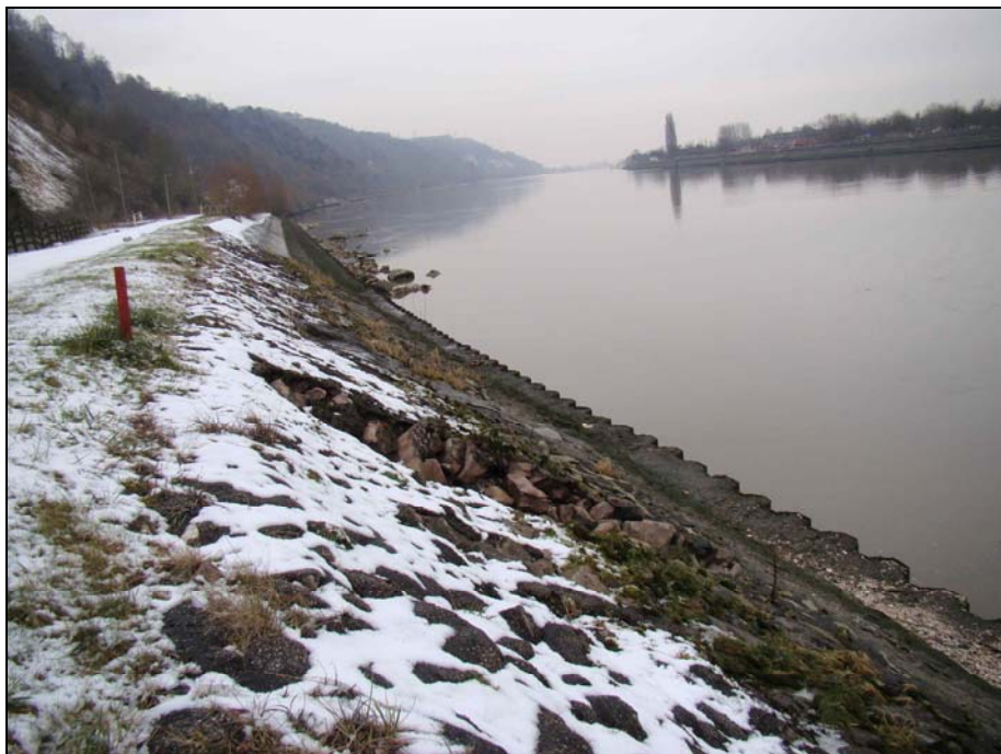
Photo 2 : Vue du même désordre, sachant que la hauteur entre le chemin et le haut des pal-planches est de 6 m.
