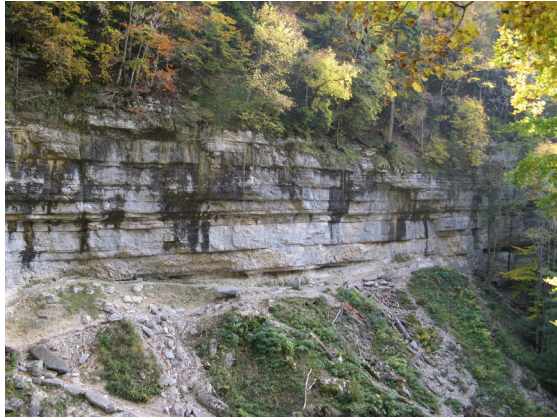
Risque d'éboulement sur le site des cascades du Hérisson (39) (photo BRGM).
