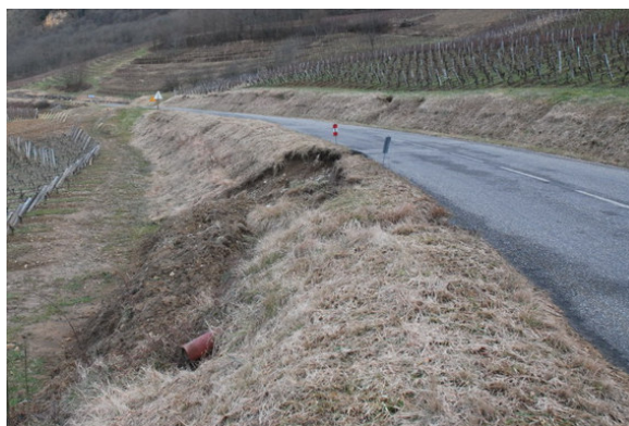
Glissement de talus routier à Château-Chinon (39) (photo BRGM).
