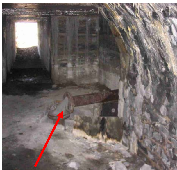
Puits intermédiaire avec canalisations de départ et d'arrivée (photo SNCF)
