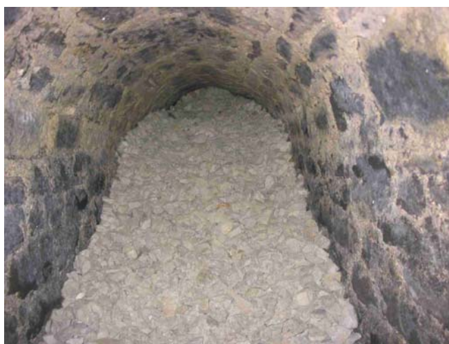
Galerie terminale comblée (entre le puits et la cheminée d'aération ; photo SNCF)
